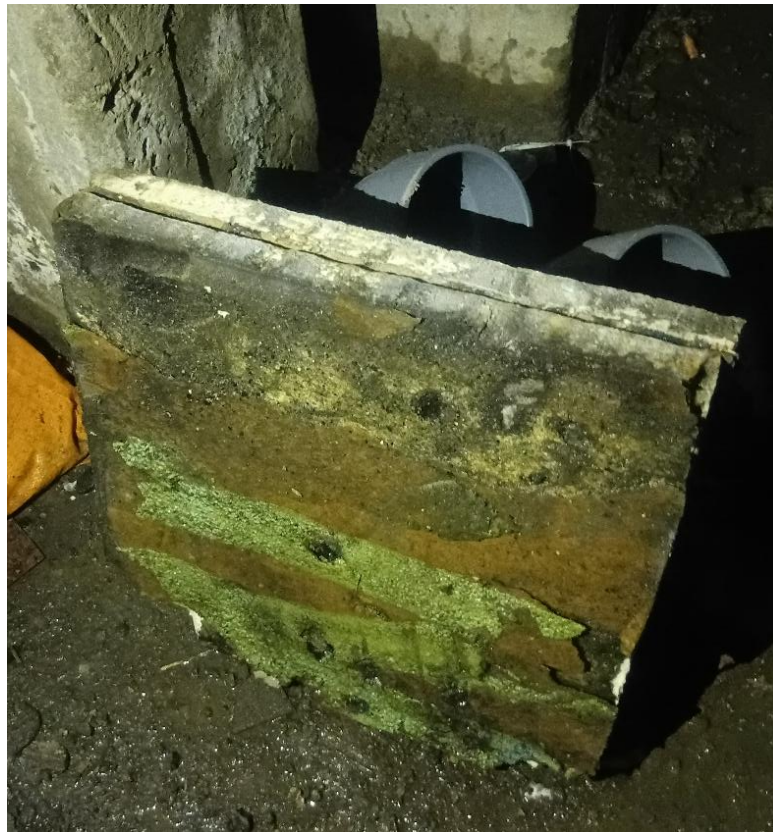
Fig. 7 - Panneau isolant qui obturait l'ouverture, retrouvé à l'intérieur de la chaufferie après l'accident Source : CNESST
