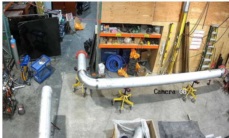
Fig. 5 – Lieu avant l'accident – vue vers l'est Source : SCV-Enercor inc., modifiée par la CNESST
