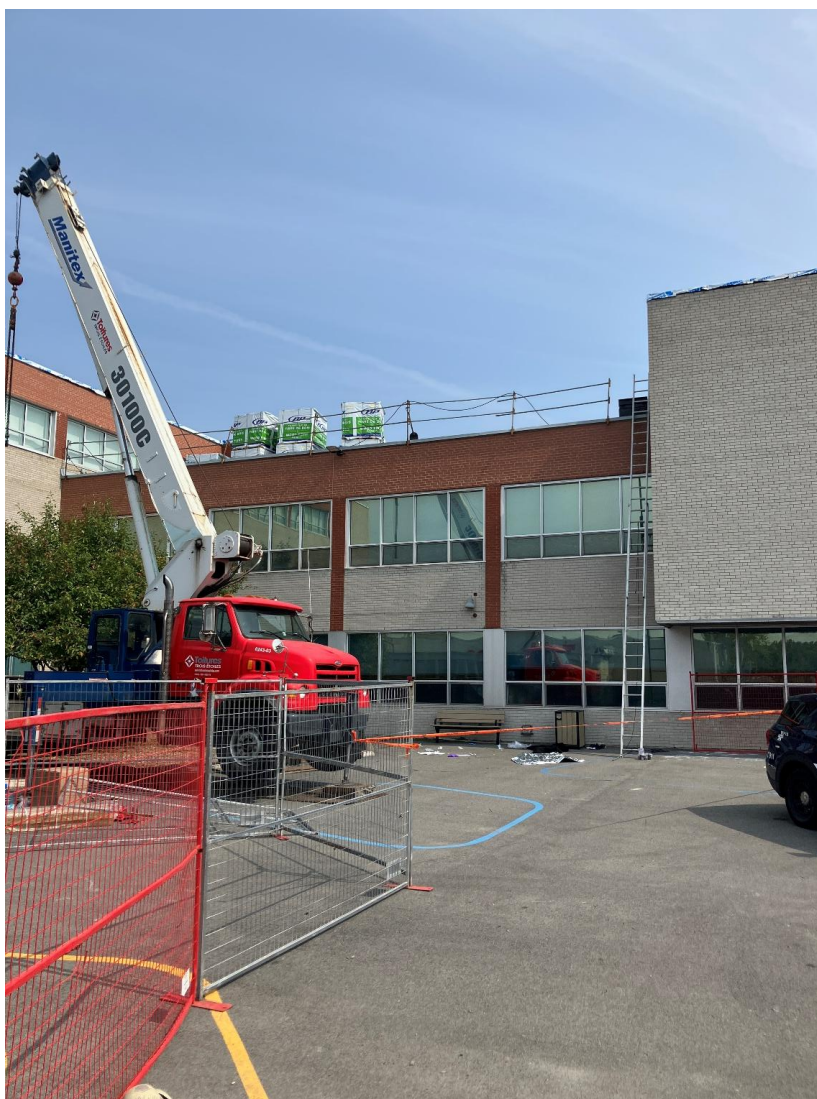
Fig. 4 - Lieu de l'accident Source : CNESST
