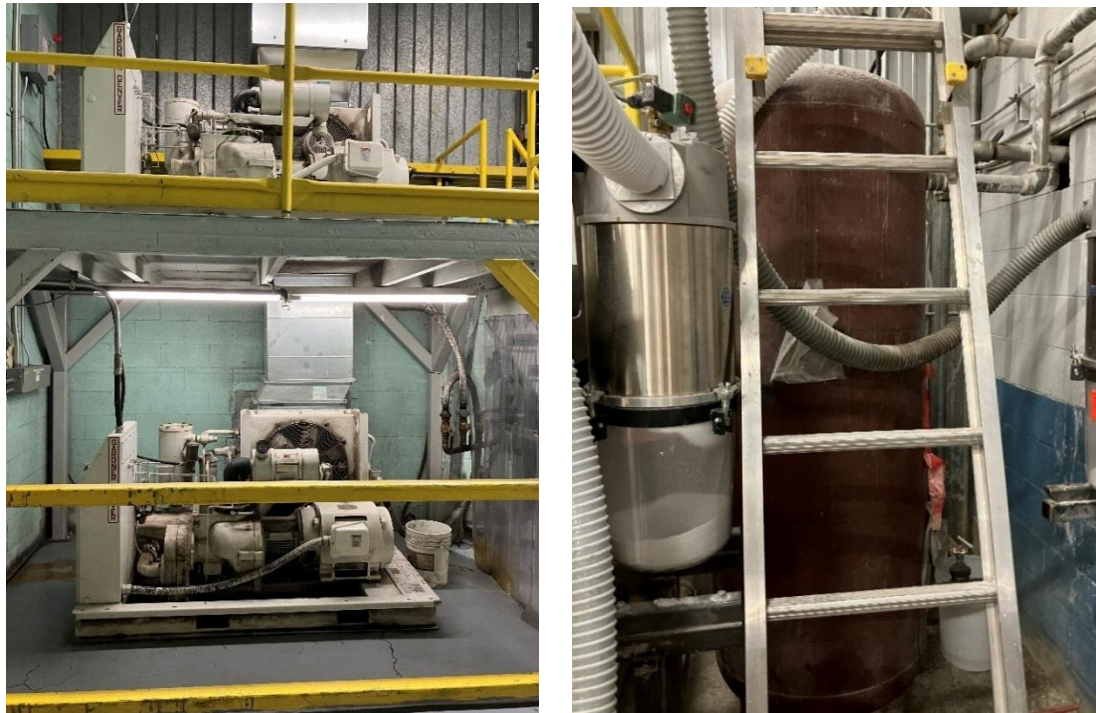
Fig. 7 - Compresseurs et grand réservoir d'air comprimé Source : CNESST
