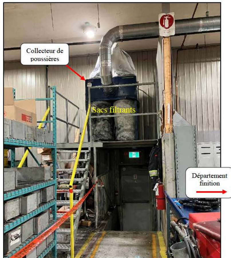
Fig. 3 – Mezzanine du collecteur de poussières Source : CNESST
