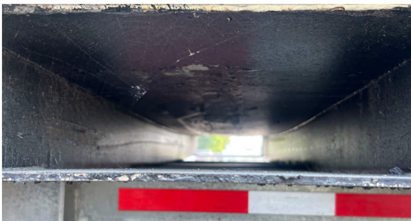
Photographie 11 : Déformation excessive en flexion du plancher du conteneur sous une des deux lisses. (Source CNESST).
