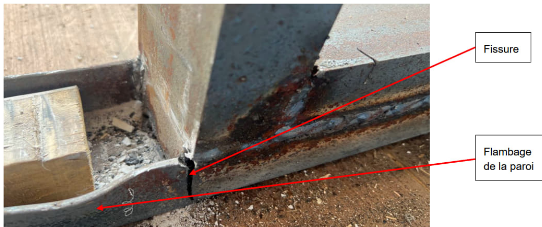
Photographie 8 : Flambage et fissuration des parois de la première lisse. (Source CNESST).
