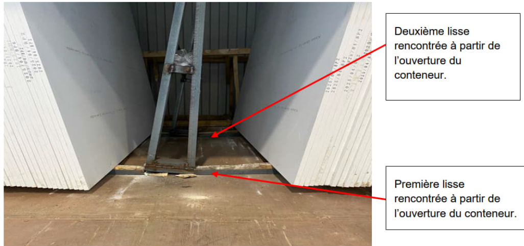
Photographie 5 : Inclinaison vers la droite des cadres verticaux du support de type A. (Source CNESST).
