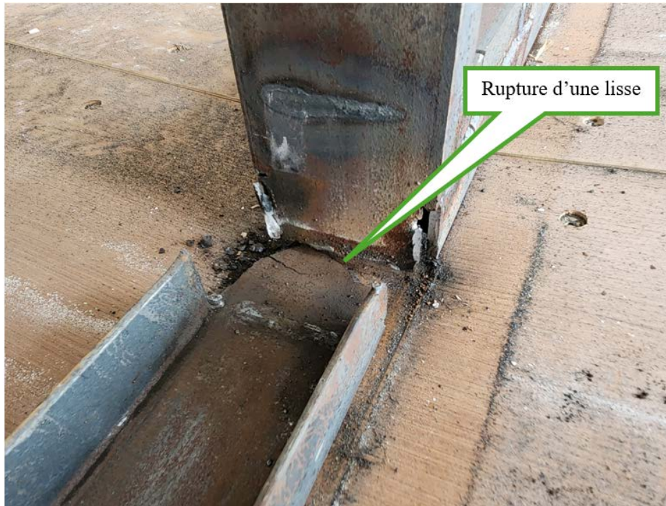
Fig. 7 – Rupture d'une des lisses du support de type A Source : CNESST
