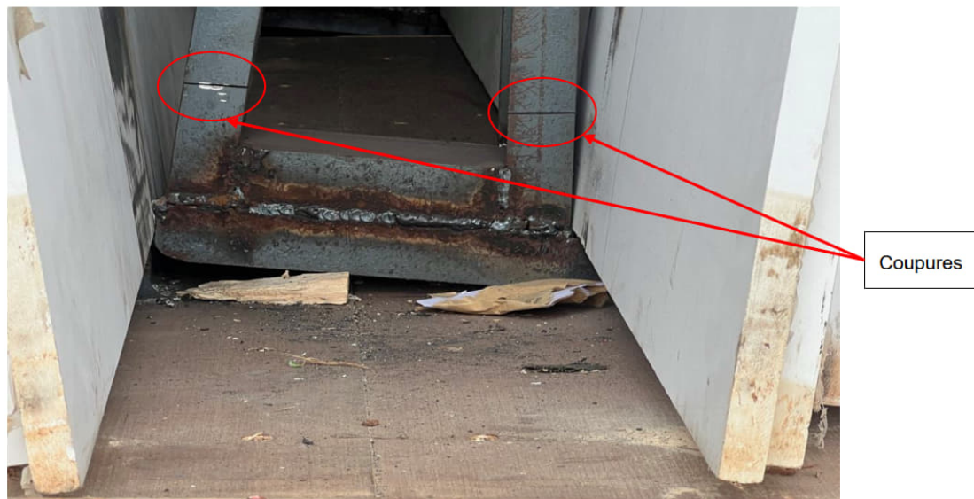
Photographie 3 : Rupture d'une lisse sur le côté gauche du support en A (Source CNESST).
