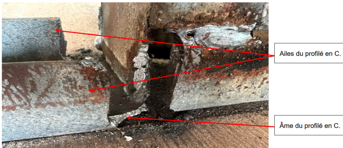
Photographie 6 : Rupture complète de la section de la première lisse. (Source CNESST).
