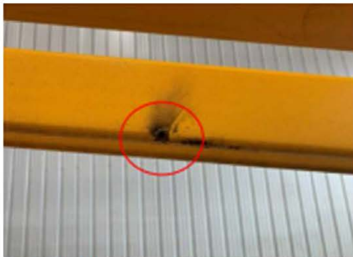
Fig. 8 - Photographie de la marque présente sur le longeron secondaire du mât principal Source : Rapport d'expertise de Cisolift Distribution inc.
