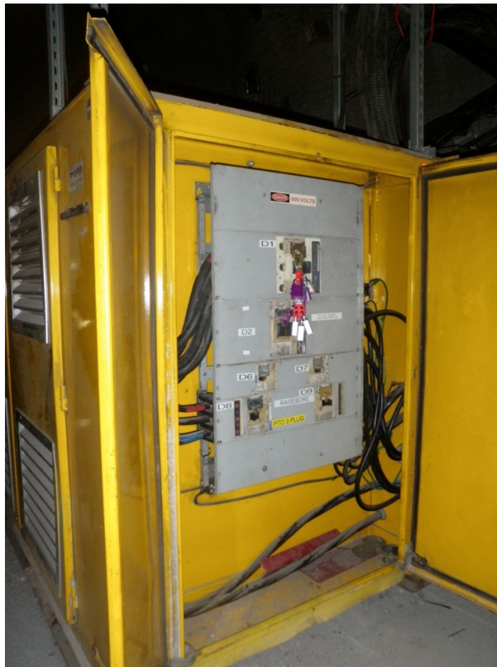
Fig. 6 – Sous-station électrique Source : CNESST
