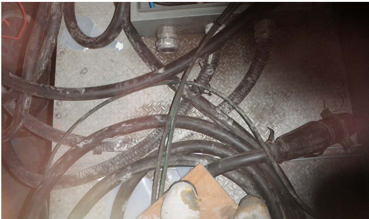
Fig. 9 – Câbles présents sur l'unité de puissance
