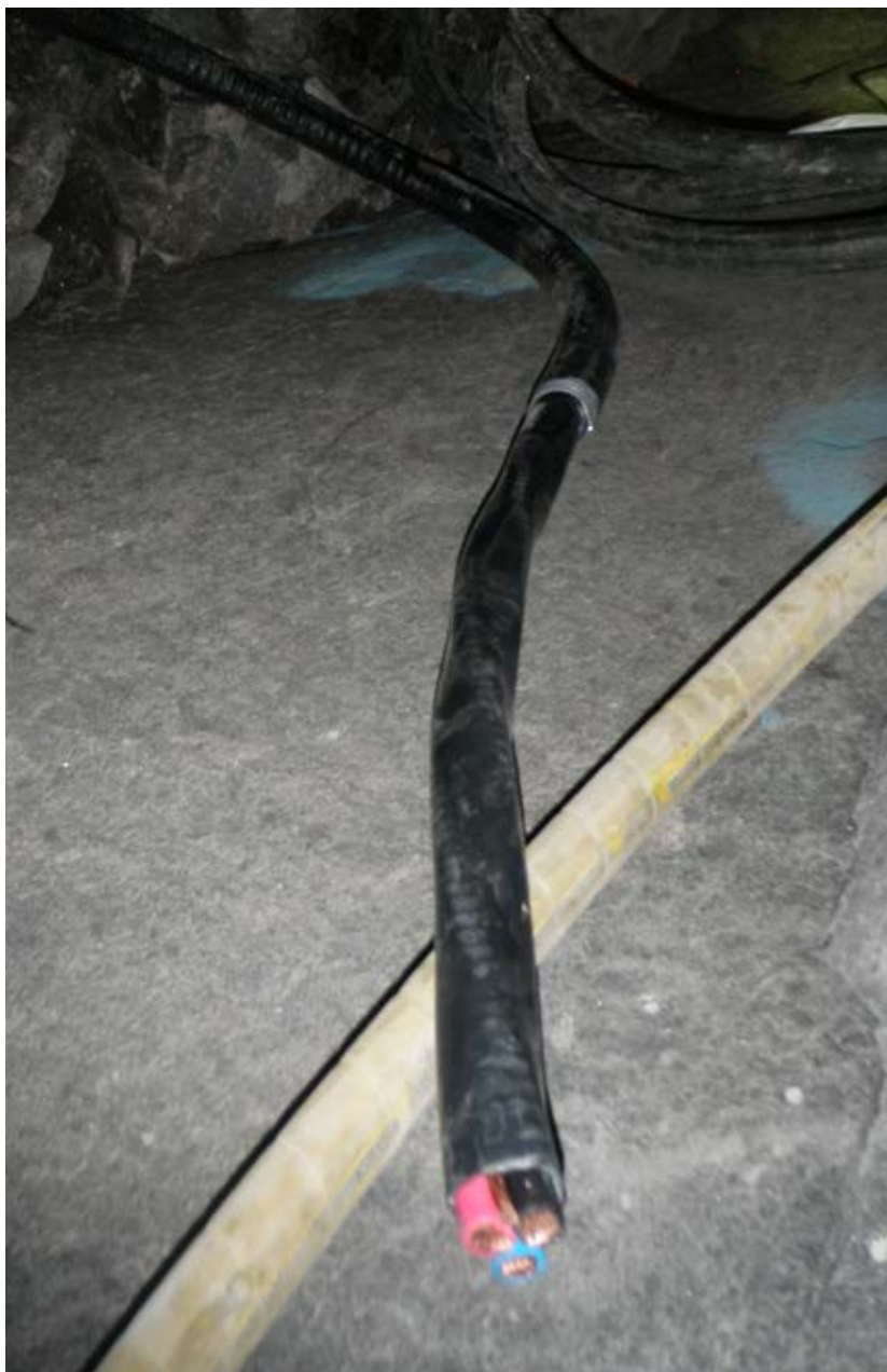
Fig. 10 – Extrémité du câble de raccordement
