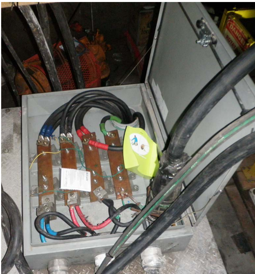
Fig. 11 – Coffret de branchement de l'unité de puissance Source : CNESST
