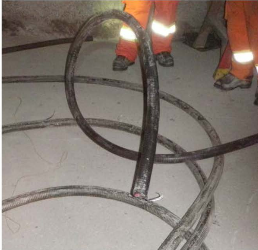
Fig. 12 – Câble de raccordement présent à la sous-station électrique
