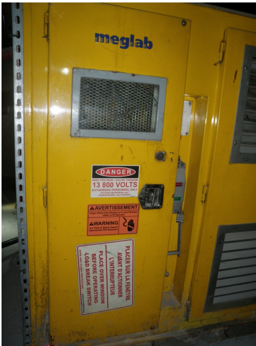
Fig. 7 – Sous-station électrique Source : CNESST
