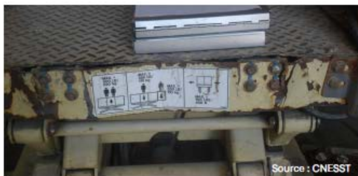
Photo 3 : Déformation et déchirure situées à l'arrière de la plate-forme de travail
