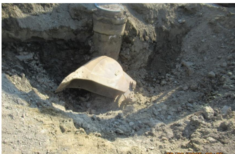
Fig. 18 - Excavation où survient l'accident
