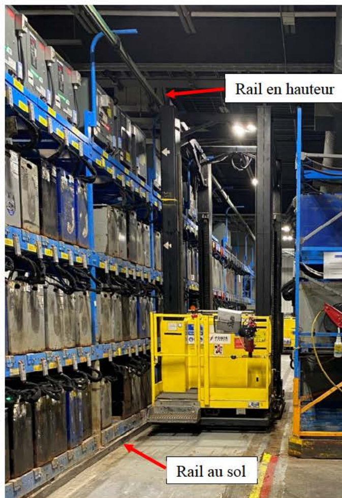
Fig. 10 – Machine de manutention de batteries se déplaçant sur des rails Source : CNESST
