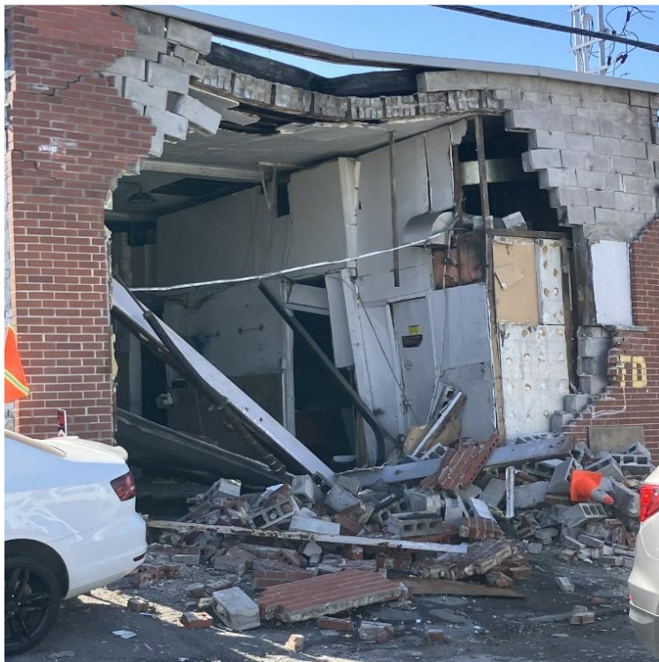
Figure 1 - Face arrière du lave-auto à la suite de l'accident
