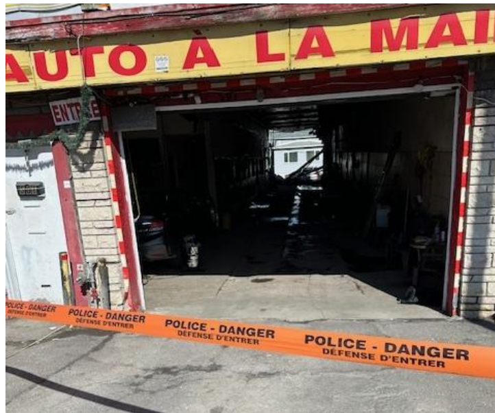
Fig. 2 - Entrée du Lave-auto Pont-Viau au 501, boulevard Des Laurentides jusqu'à la sortie rue Berri Source : CNESST
