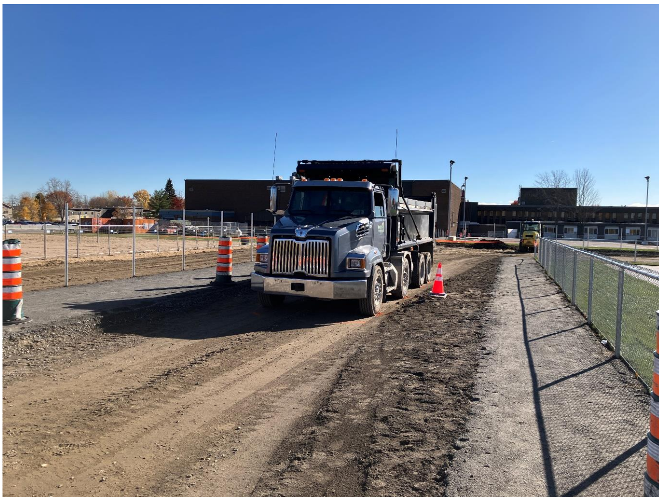
Figure 1 - Positionnement du camion à benne basculante à la suite de l'accident
