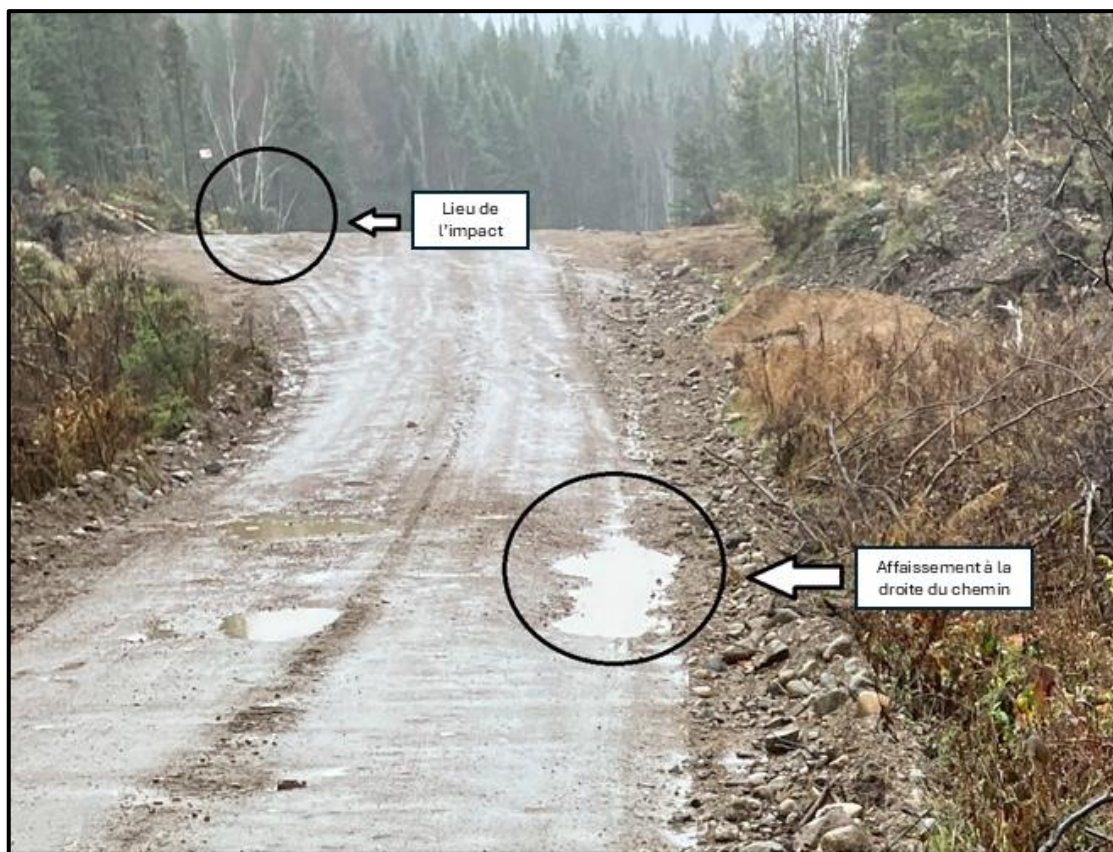
Fig. 7 - Affaissement à la droite du chemin Source : CNESST
