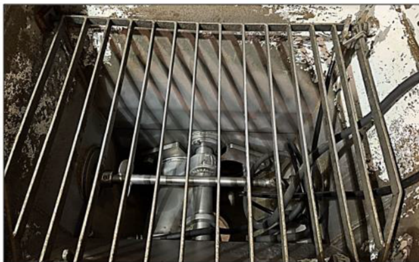
Figure 12: Intérieur de la trémie de la pompe à béton
