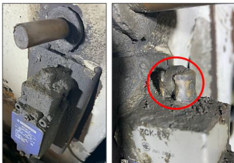
Figure 14: Poussoir à galet de l'interrupteur bloqué en position enfoncée 21
