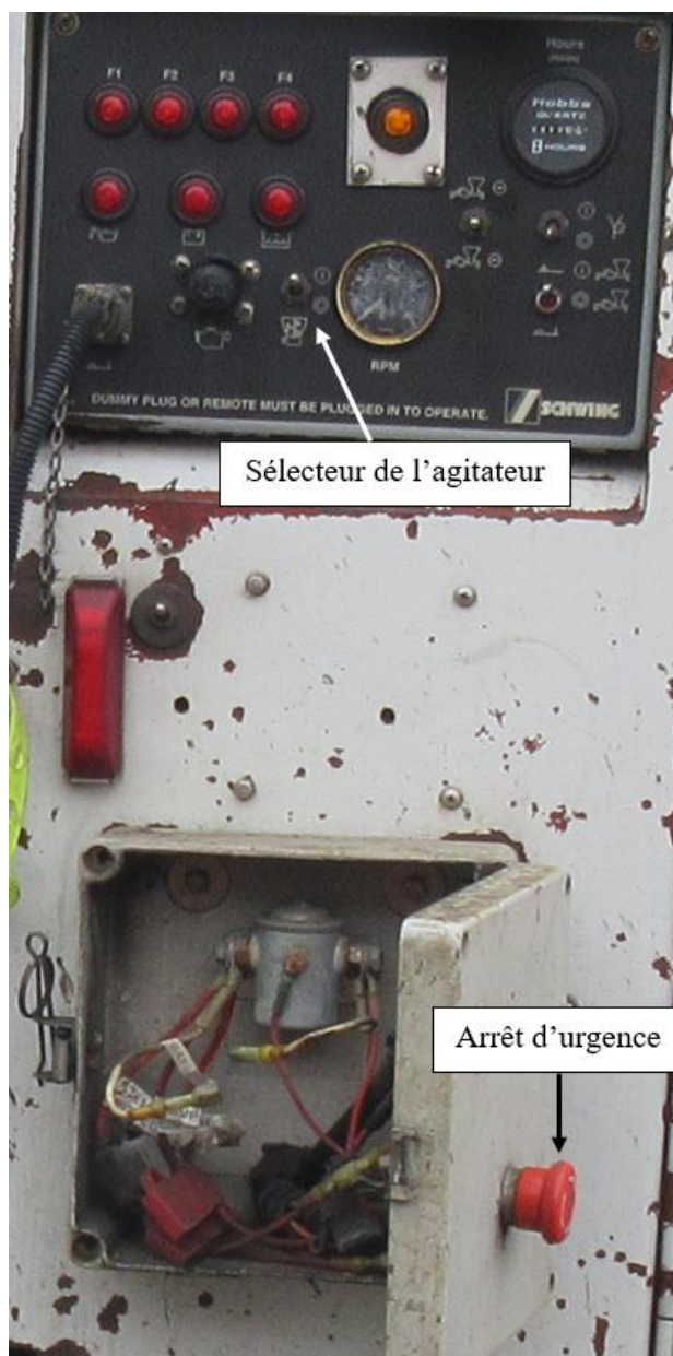
Fig. 6 : État du panneau de commande et du boîtier à l'arrivée des inspecteurs Source : CNESST
