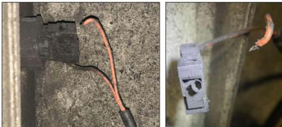
Figure 19: Fil coupé de l'arrêt d'urgence sur le côté conducteur
