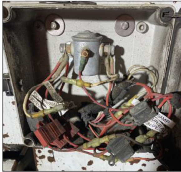
Figure 20: Intérieur du panneau de commande ajouté
