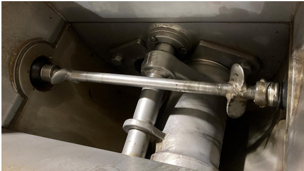
Fig. 17 : Vue de l'agitateur dans la trémie de la pompe grille relevée
