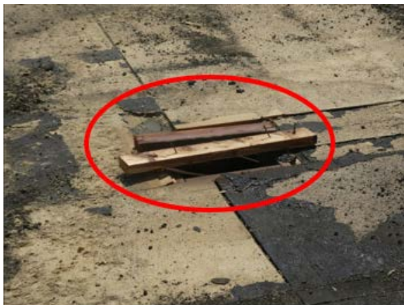
Figure 11 : Rebutts de bois (2 x 4) utilisés pour le recouvrement temporaire de l'ouverture du toit H
