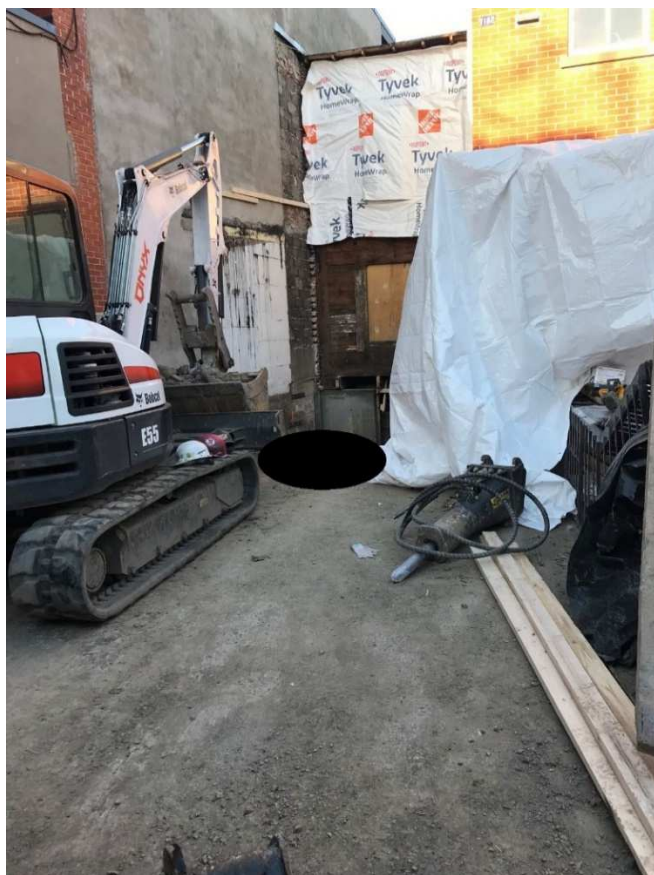
Figure 1 - Photographie du lieu de l'accident
