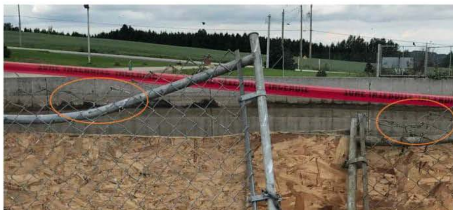
Photo 22 : Déformations locales du maillage au centre de la flexion (Source : CNESST)
