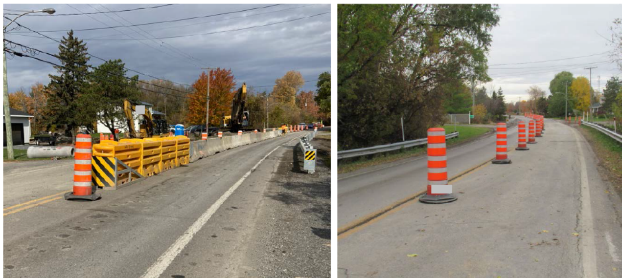
Fig. 4 et 5 : Glissières de sécurité et balises TRV-7
