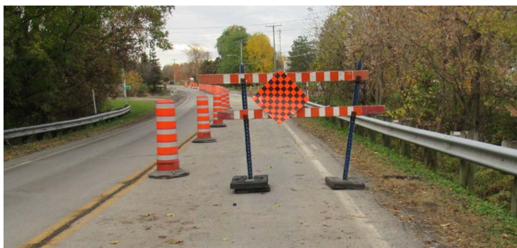
Fig. 8 : Barrière T-B-2 Source : CNESST (photo prise le lendemain de l'accident)
