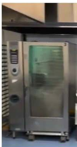
Fig. 4 -Four situé dans la cuisine Source : CVA
