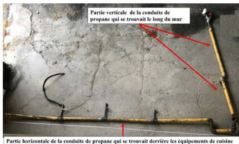
Fig. 13 -Photographie de la conduite de propane de la cuisine et ses sorties
