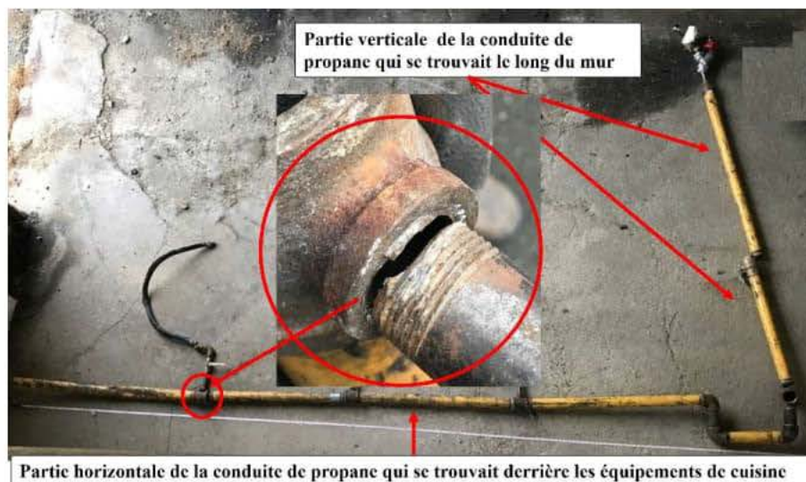
Fig. 15 -Sortie cassée correspondant à la tuyauterie flexible du four.
