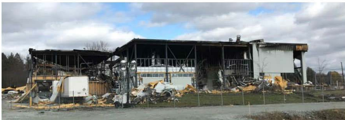
Fig. 8 -Photographie des dommages côté ouest du bâtiment Source : CNESST
