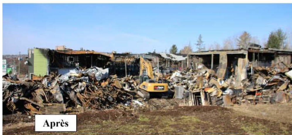
Fig. 6 -Photographie des dommages côté est du bâtiment Source : Google Maps et CNESST
