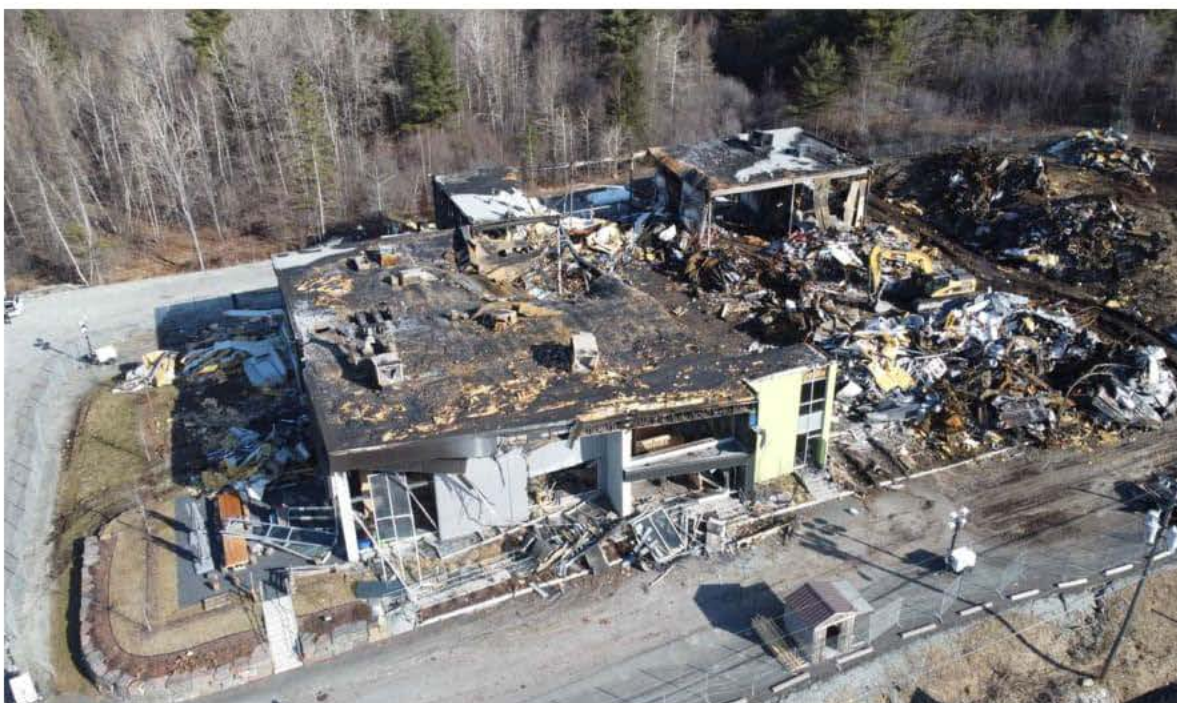
Figure 1 -Photographie des dommages sur le bâtiment à la suite de l'événement
