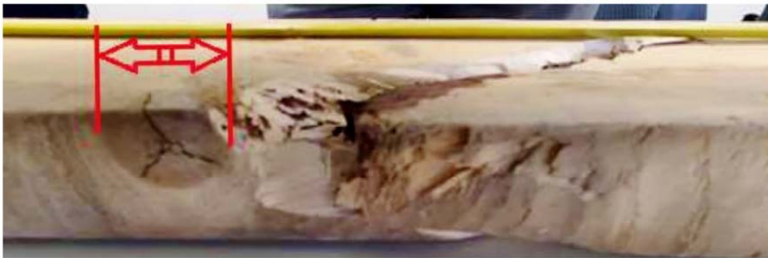
Figure 8 – Nœud près du plan de rupture Source : SDM consultants (modifiée CNESST)
