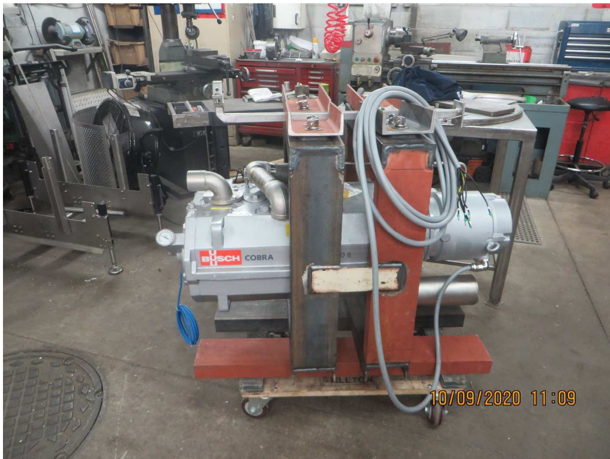
Photo 4 : Nouvelle pompe Busch Cobra NC 0500 B L03
