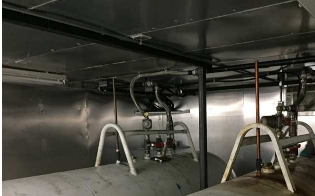
Photo 2 : Intérieur de la chambre des réservoirs
