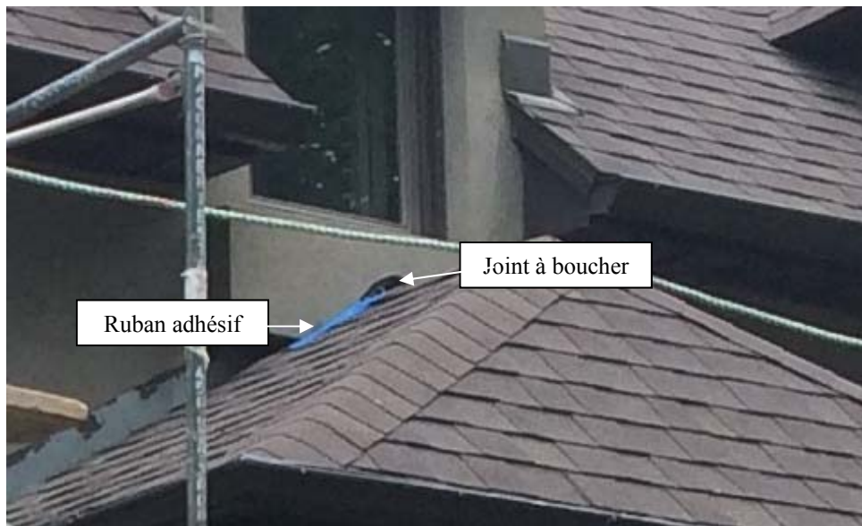
Photo 3 : Pignon de la toiture (source CNESST)
