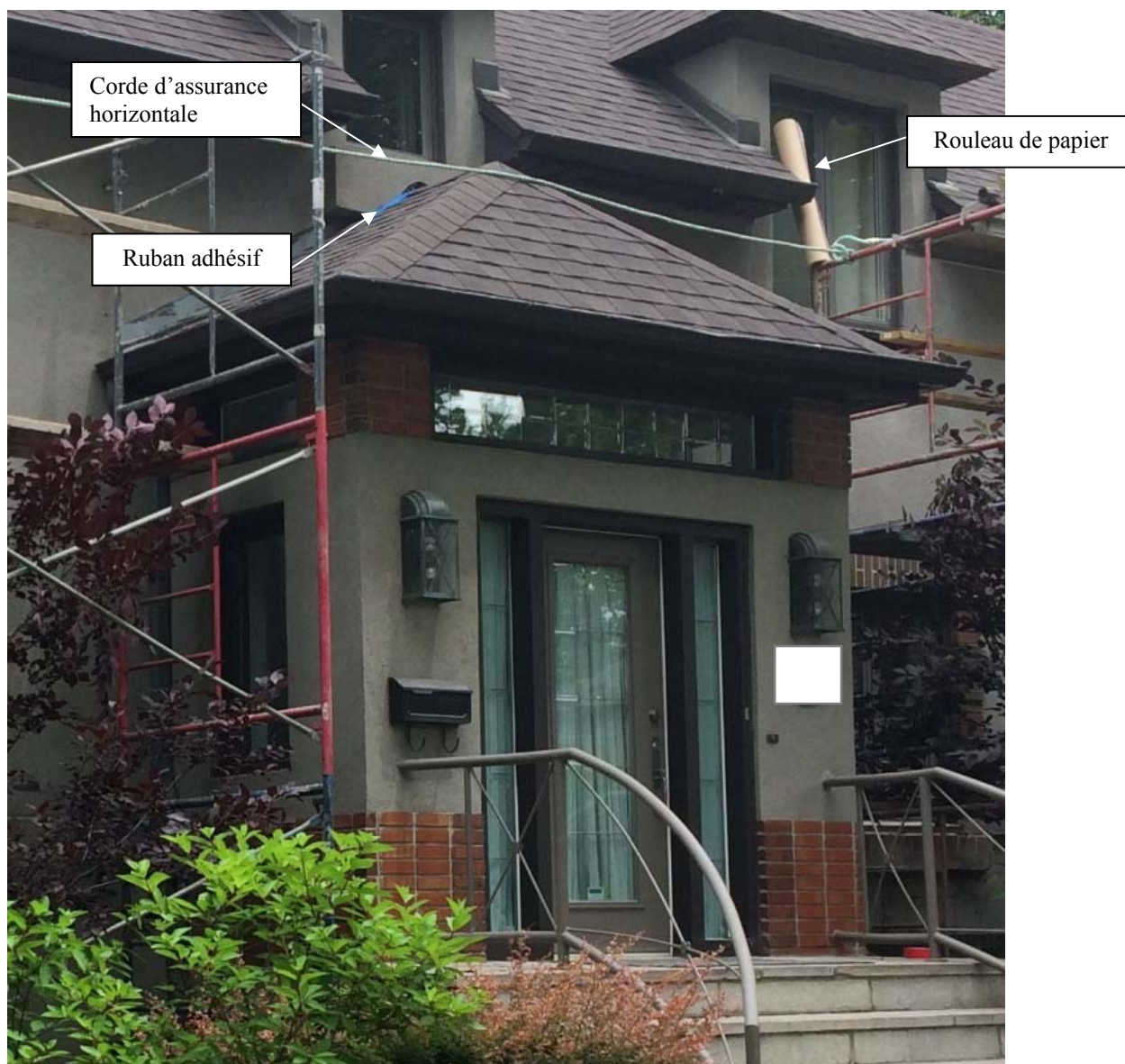
Photo 5 : Équipements (source CNESST)
