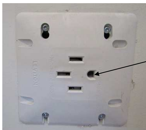
Photo 5 : Prise électrique de la cuisinière
