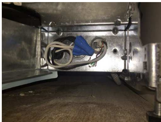
Photo 7 : Branchements électriques du lave-vaisselle (Source : Nadeau Ultra Tech)
