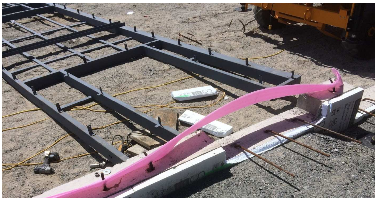
Photo 4 : Section de mur M7 tombée et ses deux tiges d'ancrage pliées (Source : CNESST)
