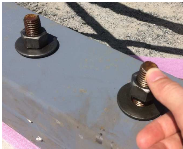
Photo 6 : Exemple de tiges d'ancrage boulonnées (Source : CNESST)
