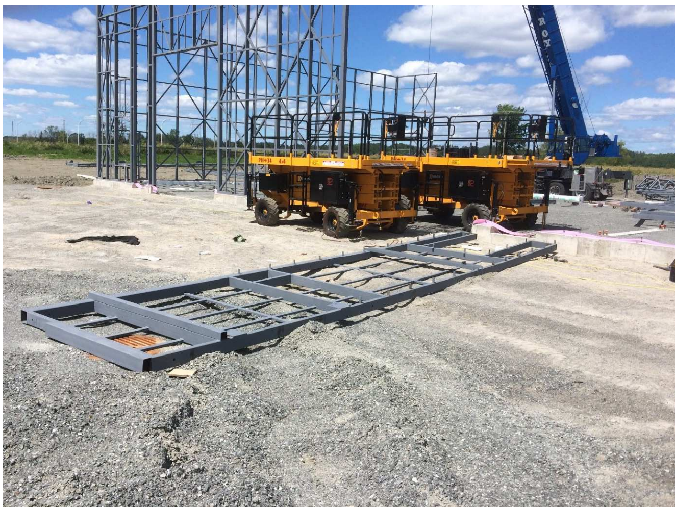
Photo 1 : Section de mur tombée sur le travailleur (Source : CNESST)
