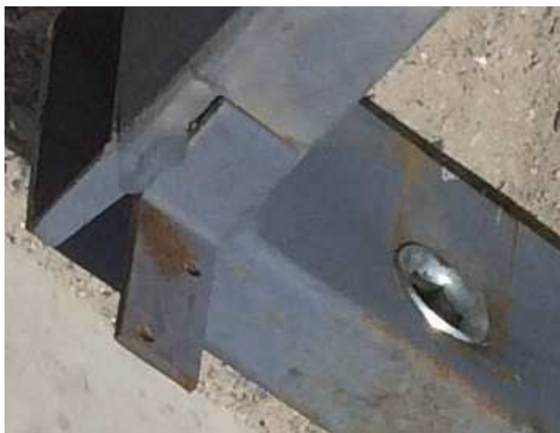
Photo 5 : Rondelle et paroi M7 enfoncés (Source : CNESST)
