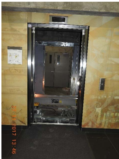
Photo 3 : Ascenseur no.4, deux portes palières ouvertes Photo prise à partir de l'entrée palière desservant le hall d'entrée principal du bâtiment Source : CNESST
