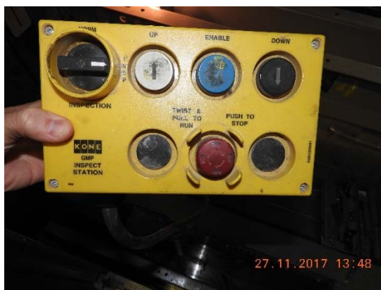
Photo 11 : Dispositif de commande pour l'inspection sur le toit de la cabine Source : CNESST
