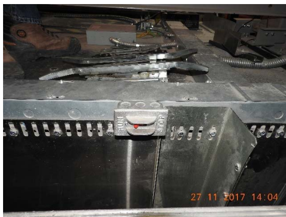
Photo 12 : Interrupteur d'arrêt sur le toit de la cabine Source : CNESST
