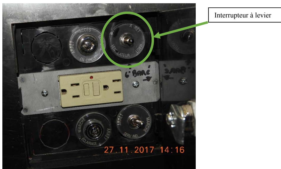
Photo 5 : Panneau verrouillé situé sous le tableau de commande Photo prise à l'intérieur de la cabine de l'ascenseur no.4 Source : CNESST
