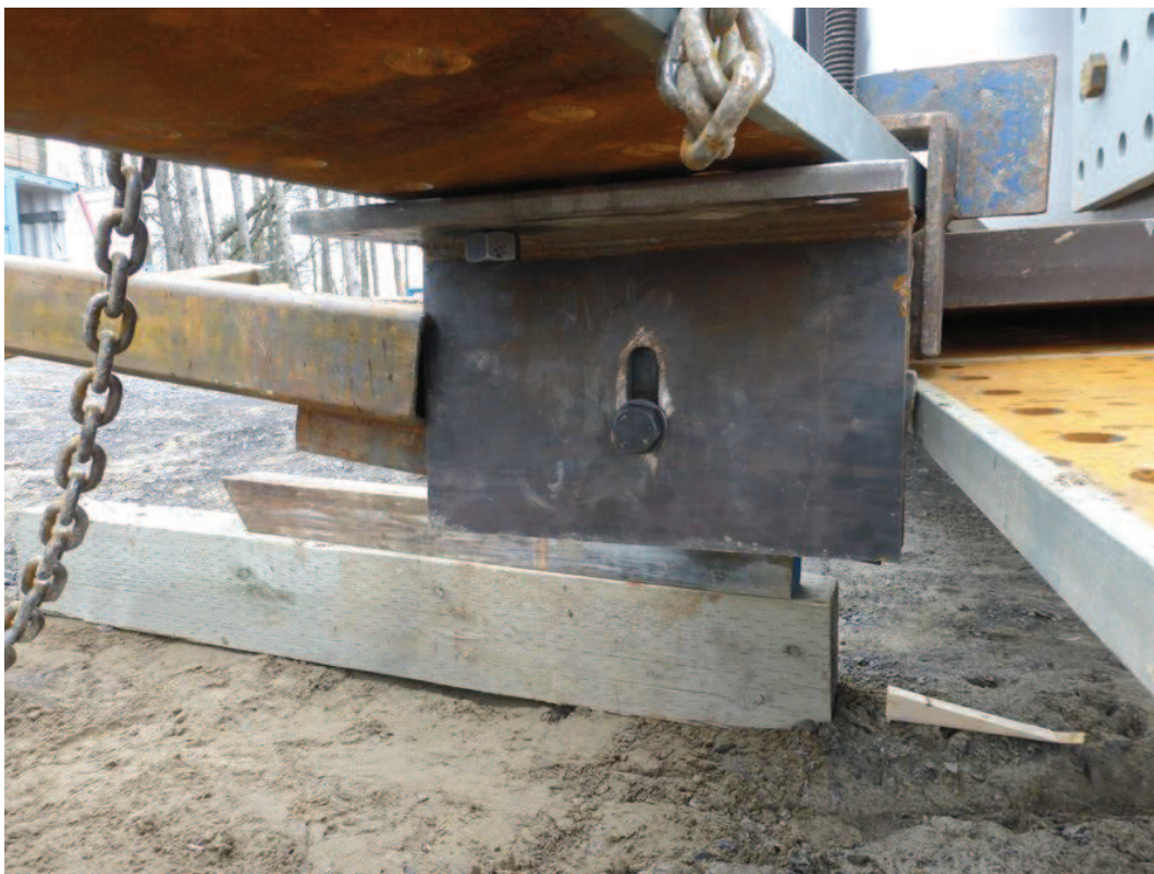
Figure 23 – Démonstration du peu de jeu existant entre l'extrémité du tube et les faces verticales des plaques d'ancrage (côté Montréal)
