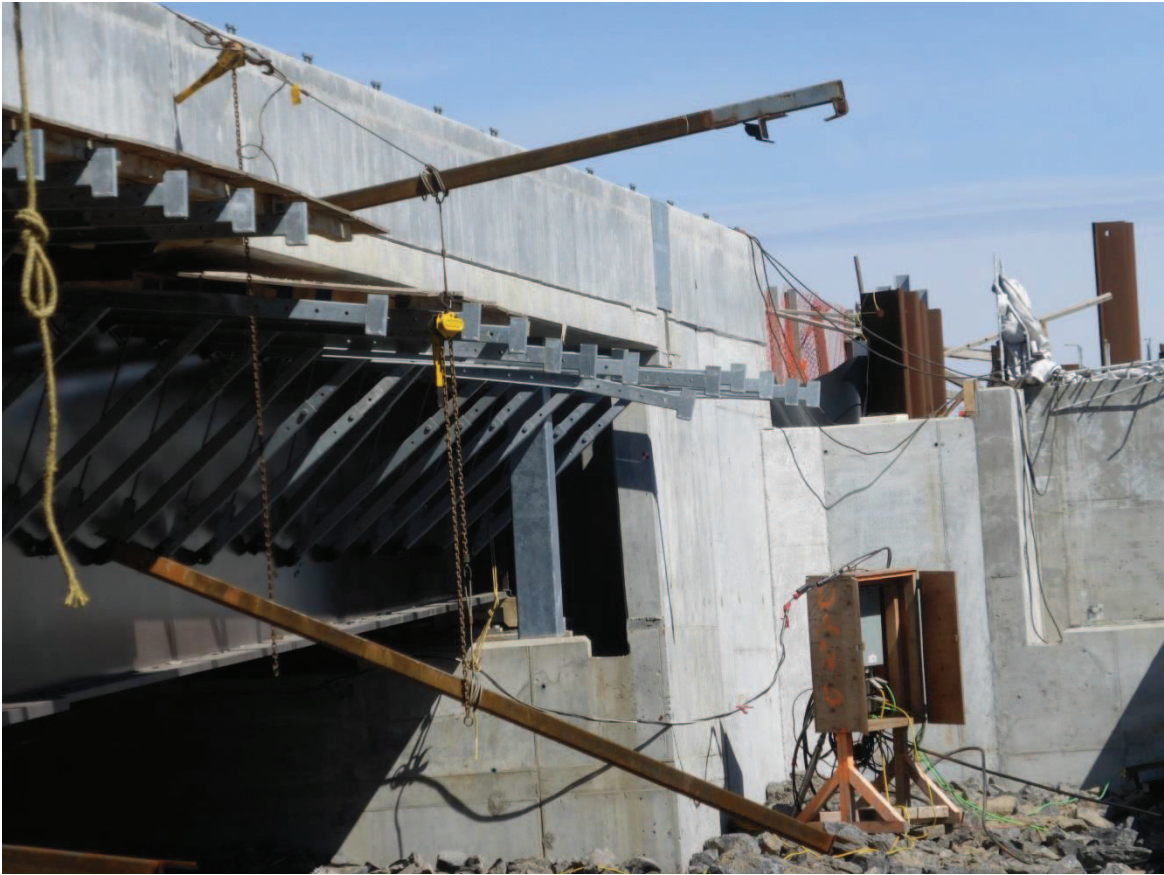
Figure 29 – Vue du support latéral temporaire situé du côté est (Québec)
