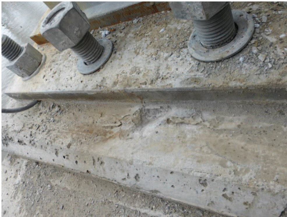
Figure 44 – Trace d'impact de forme carrée laissée dans le béton
