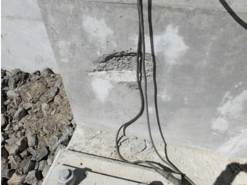
Figure 58 – Marque laissée dans le béton par l'impact de l'aile inférieure de la poutre lors du déversement
