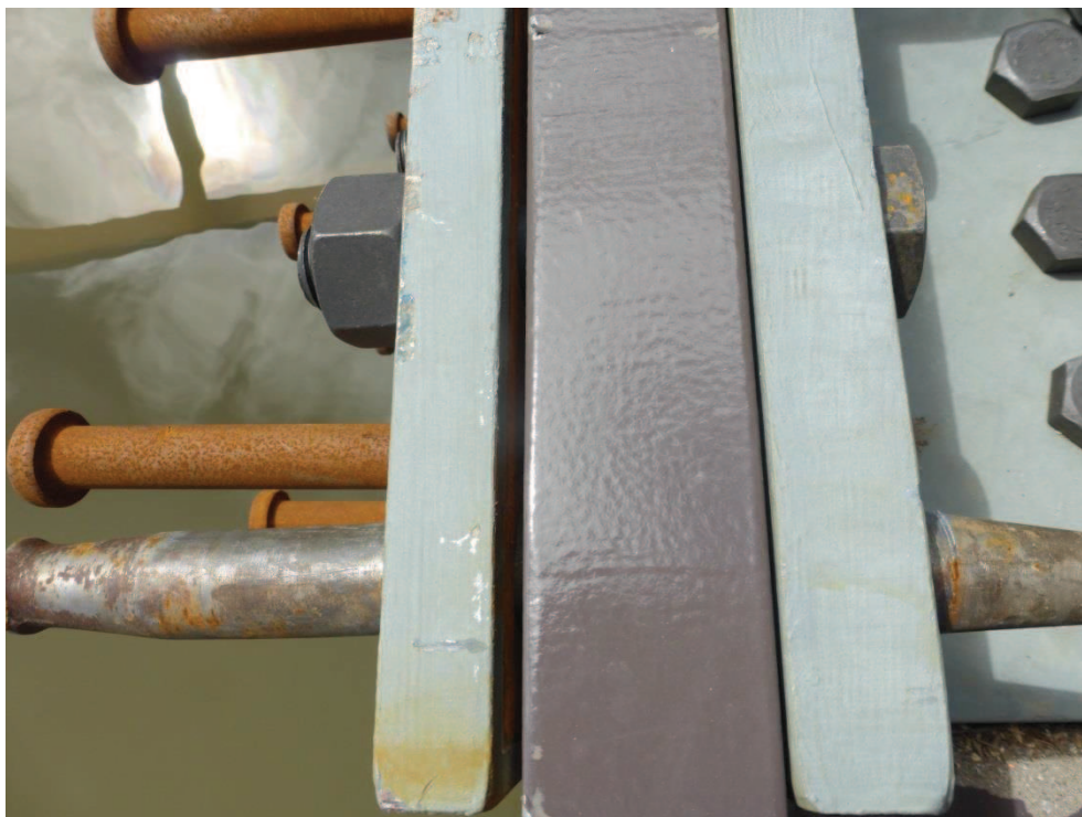
Figure 8 – Vue rapprochée de l'écart entre la plaque de recouvrement et l'aile en compression
