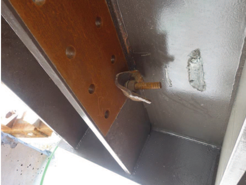
Figure 56 – Déchirure de la plaque proprement soudée à la diagonale de contreventement et boulonnée au raidisseur central à l'extrémité est de la poutre P4
