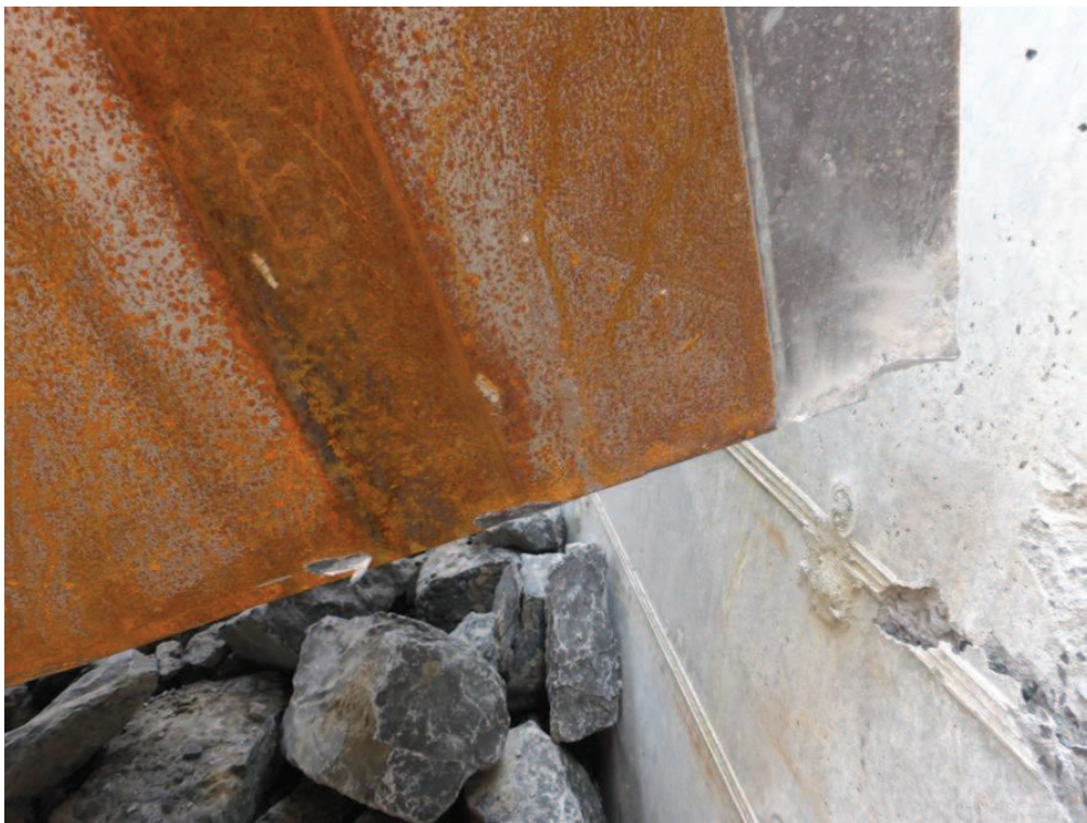
Figure 50 – Traces d'impact laissées sur la paroi sud de la semelle inférieure
