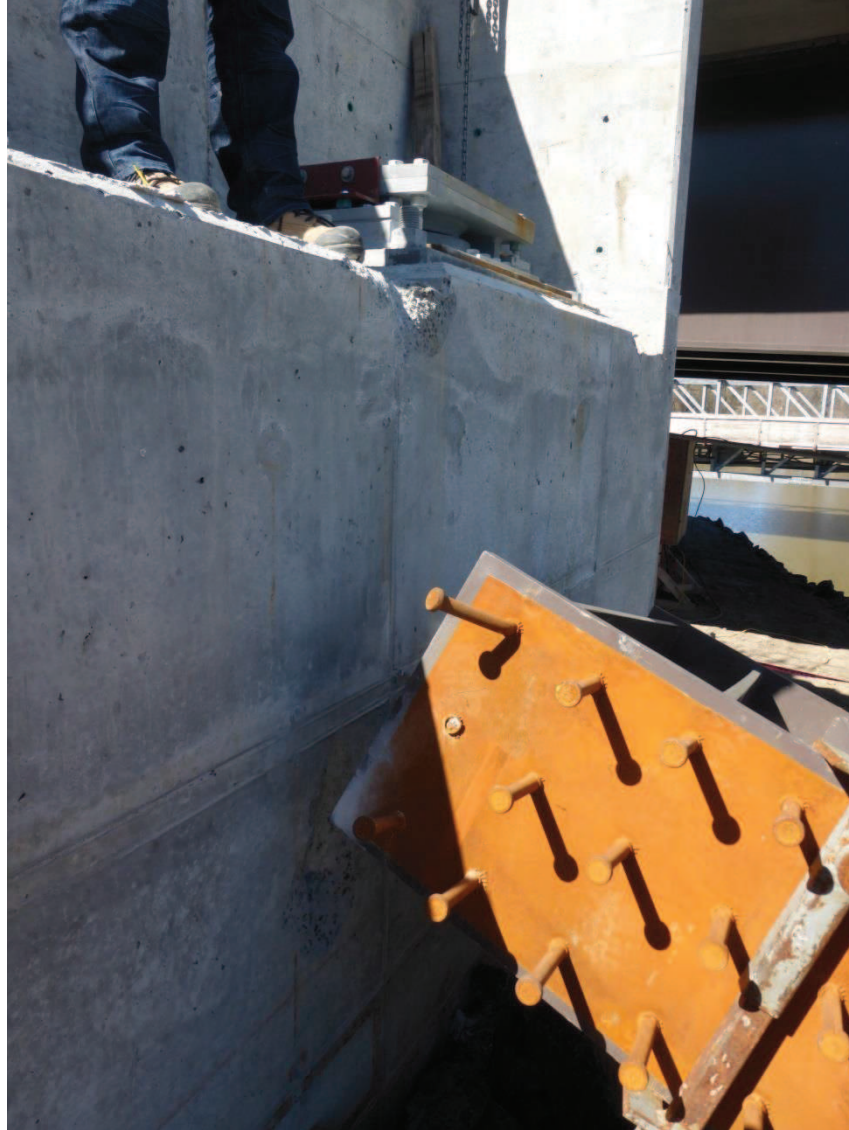
Figure 51 – Position finale de la poutre déversée au pied de la base de béton
