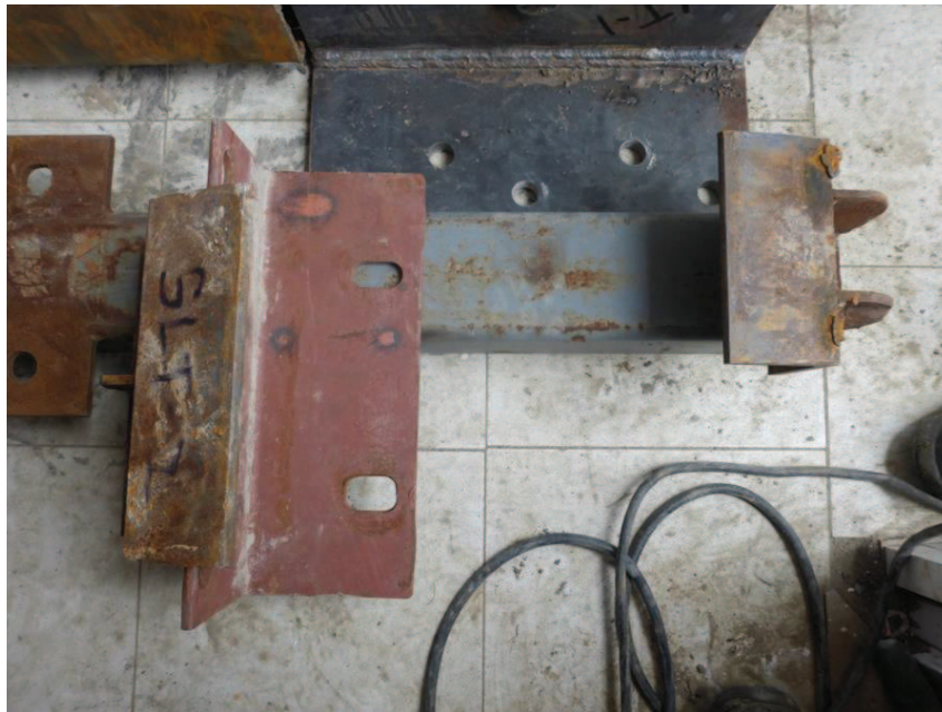
Figure 31 – Autre vue de l'extrémité sud du SLT situé du côté est, montrant le degré d'ouverture de la cornière qui fait partie du « pouce »
