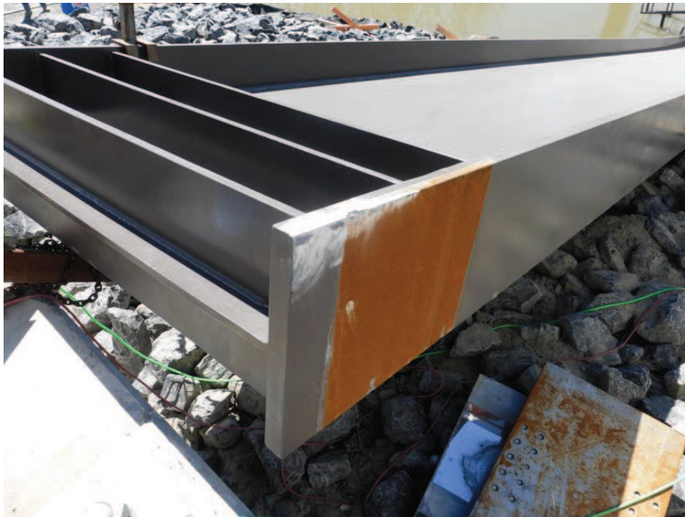
Figure 59 – Traces laissées sur la poutre par l'impact contre la façade de béton
