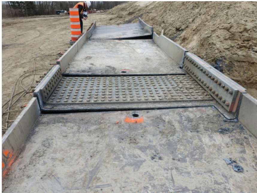
Figure 12 – Le joint de montage préalablement assemblé était en parfait état après la chute de la poutre
