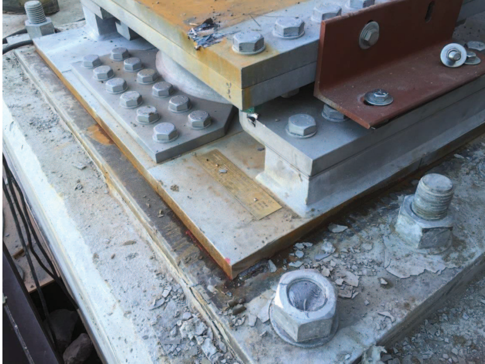
Figure 49 – Traces d'impact laissées par la poutre sur l'appareil d'appui
