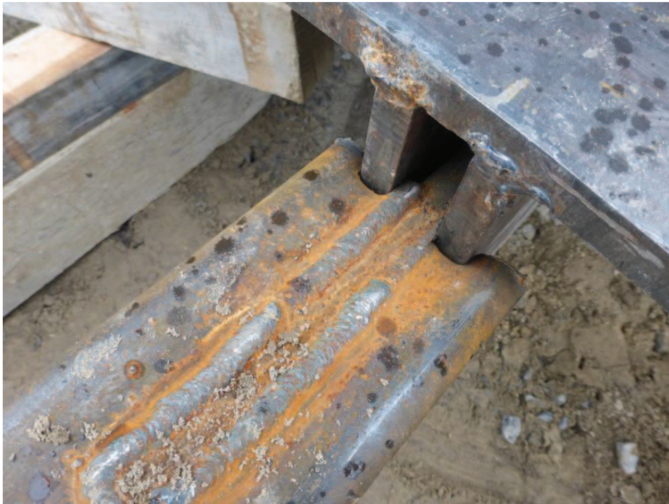
Figure 26 – Enfoncement des parois verticales de l'appareil d'ancrage dans la paroi supérieure du SLT du côté de Montréal (voir aussi la Figure 24)
