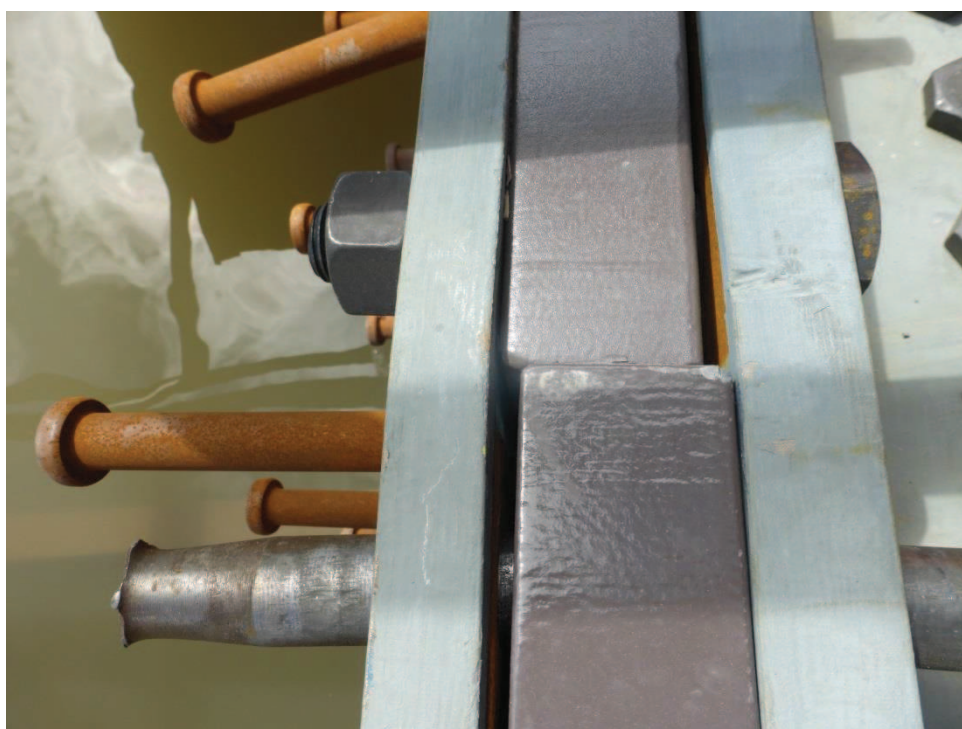
Figure 9 – Jeu très marqué entre les composantes de l'aile en compression
