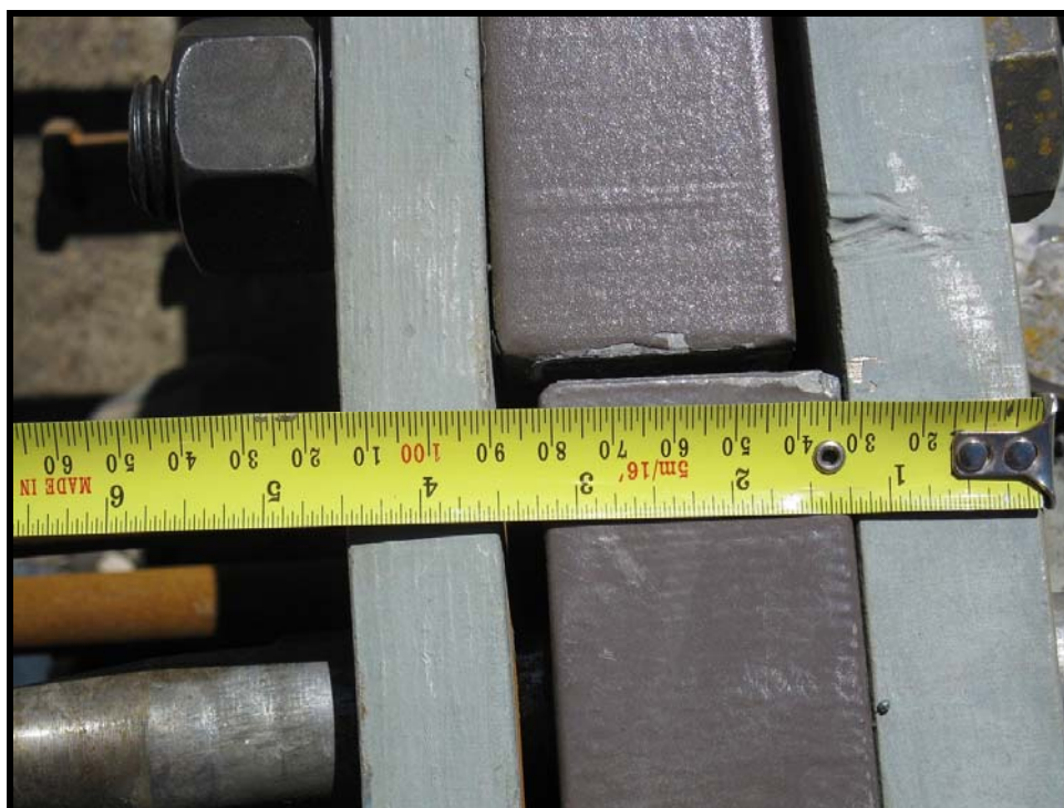
Photo 17 : Écartement des plaques sur la semelle supérieure en compression Source : CNESST (4236)
