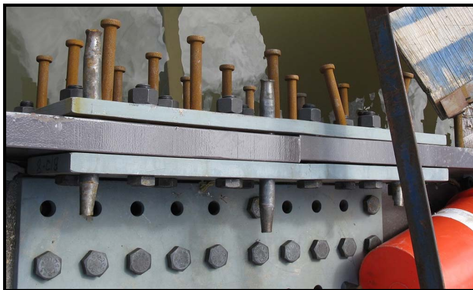
Photo 16 : Écartement des plaques sur la semelle supérieure en compression Source : CNESST (4128)
