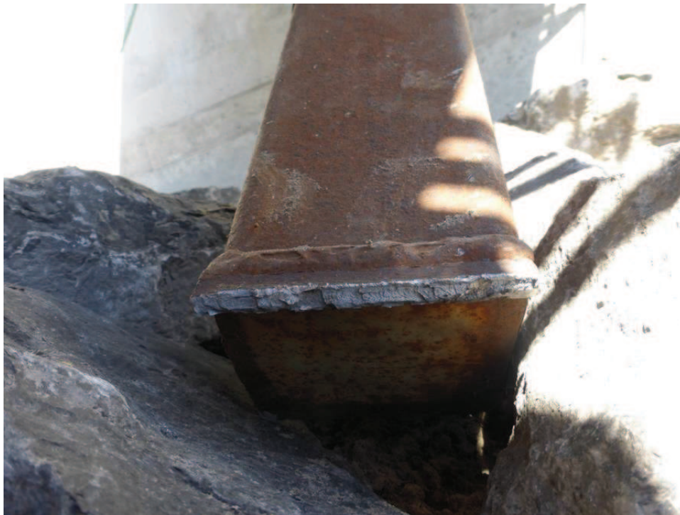
Figure 57 - Déchirure de la plaque soudée à la diagonale de contreventement
