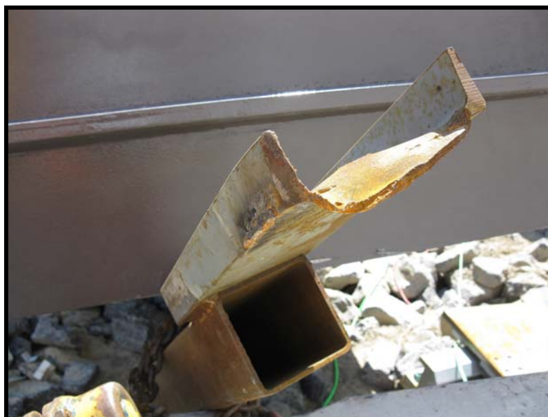
Photo 14 : Contreventement latéral du côté est arraché lors du déversement
