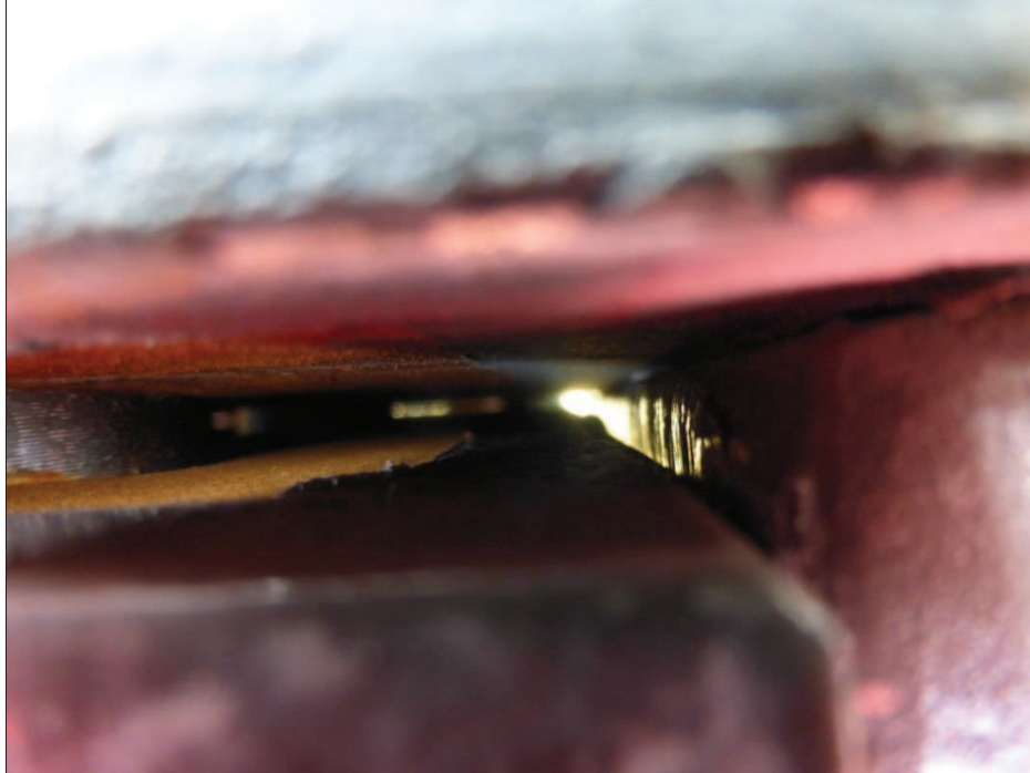
Figure 10 – Vue de l'écart important entre le bout des plaques principales à l'extrémité sud de l'aile en compression (tout juste au-dessus de l'eau)
