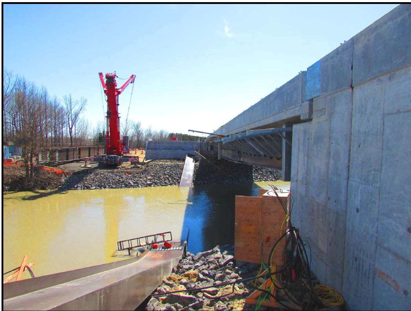
Photo 1 : La poutre P4 effondrée.
