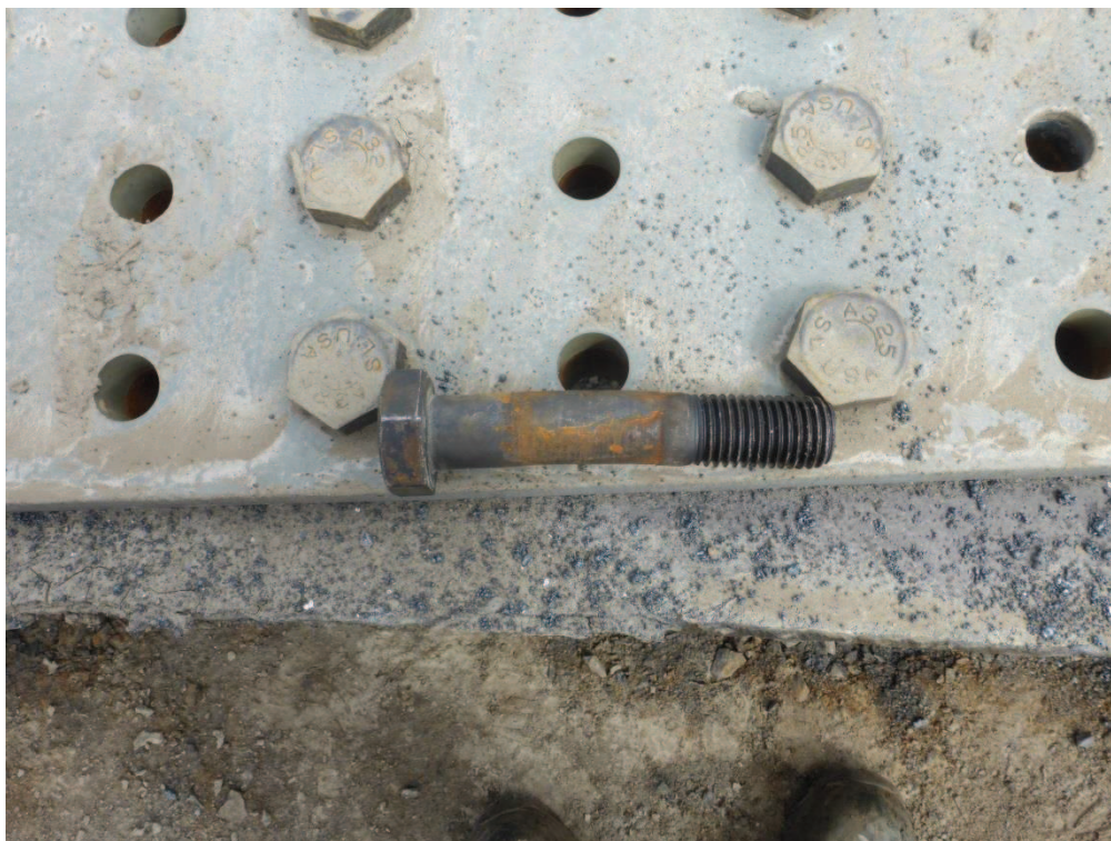
Figure 15 – Déformation prononcée caractéristique d'un des boulons de l'assemblage
