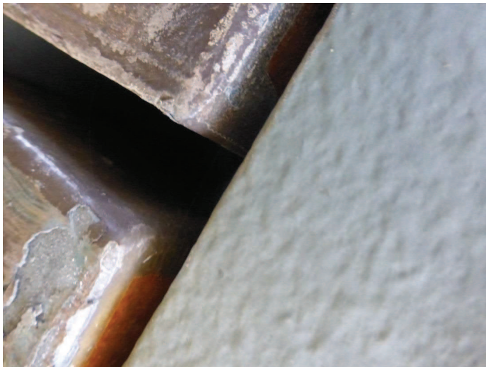
Figure 11 – Vue de l'écart très important entre le bout des plaques principales à l'extrémité sud l'aile en traction (tout juste au-dessus de l'eau)
