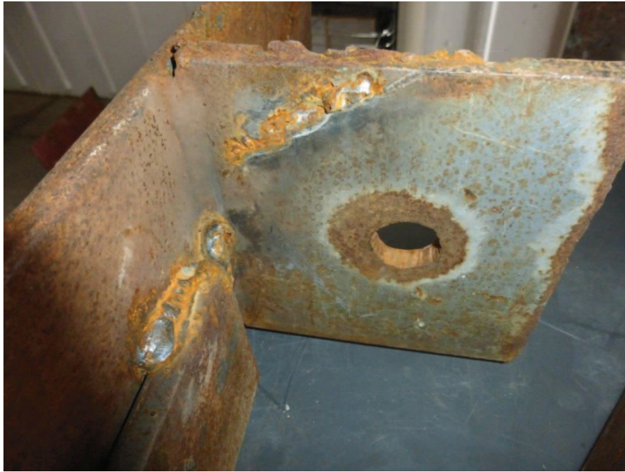
Figure 54 – Cordons de soudure visibles sur le connecteur inférieur du support de verticalité
