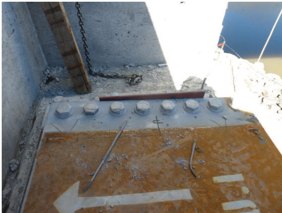
Figure 48 – Traces d’impact laissées par la poutre sur les boulons et la plaque
