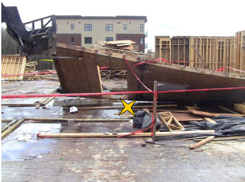
Photo 3 : Emplacement du travailleur lors du renversement du mur (Source : CNESST)
