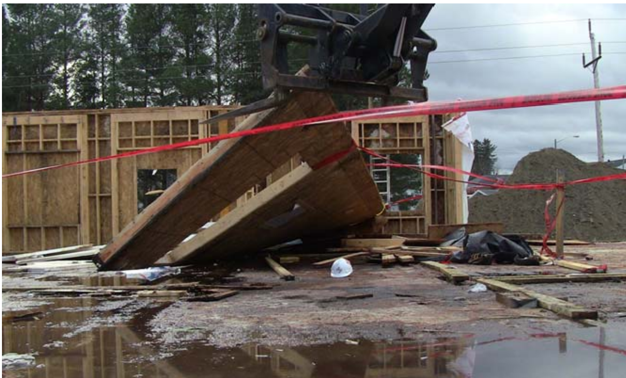
Photo 1 : Lieu de l'accident (Source : CNESST)
