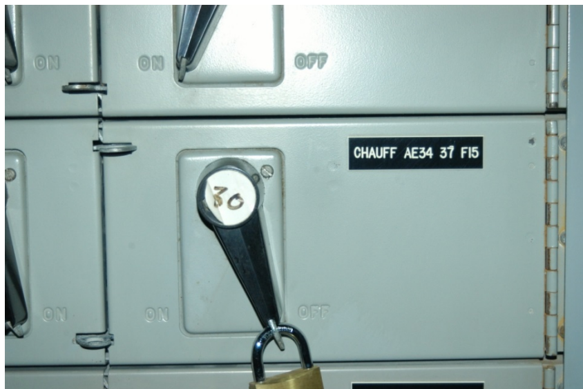
Photo 7 : Disjoncteur (Source : CNESST)
