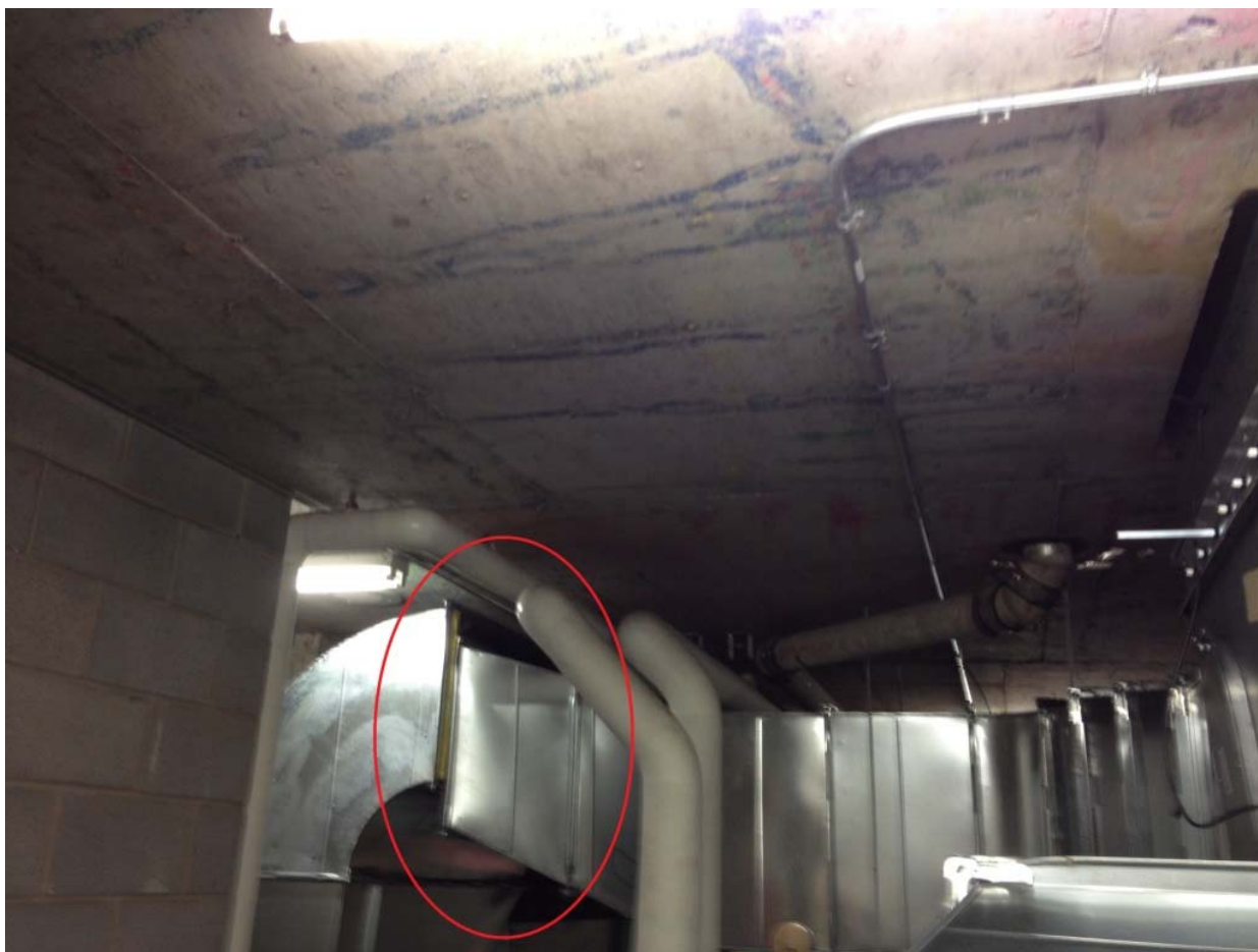
Photo 4 : Conduits à remplacer (Source : C-nergie)
