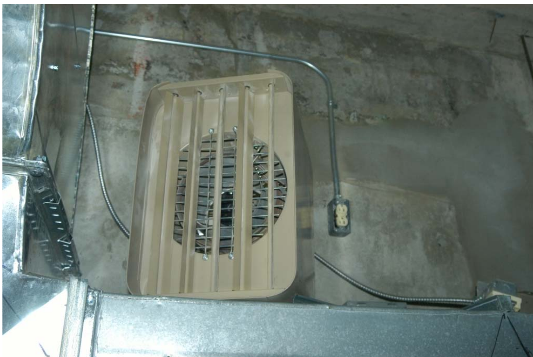
Photo 5 : Aérotherme (Source : CNESST)
