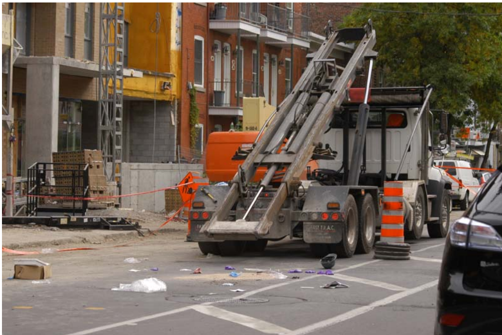
Vue derrière le camion : source CNESST
