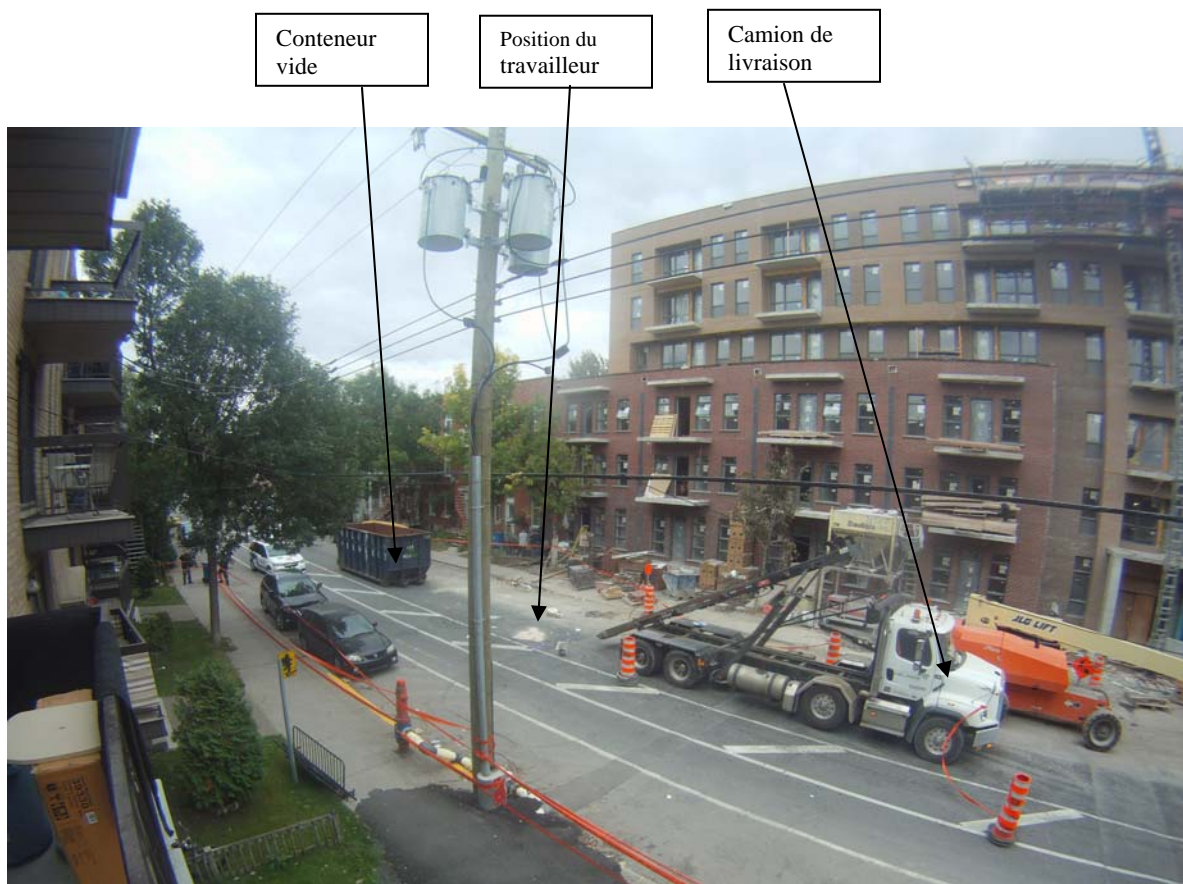
Photo 1 : Lieu de l'accident (source : CNESST)
