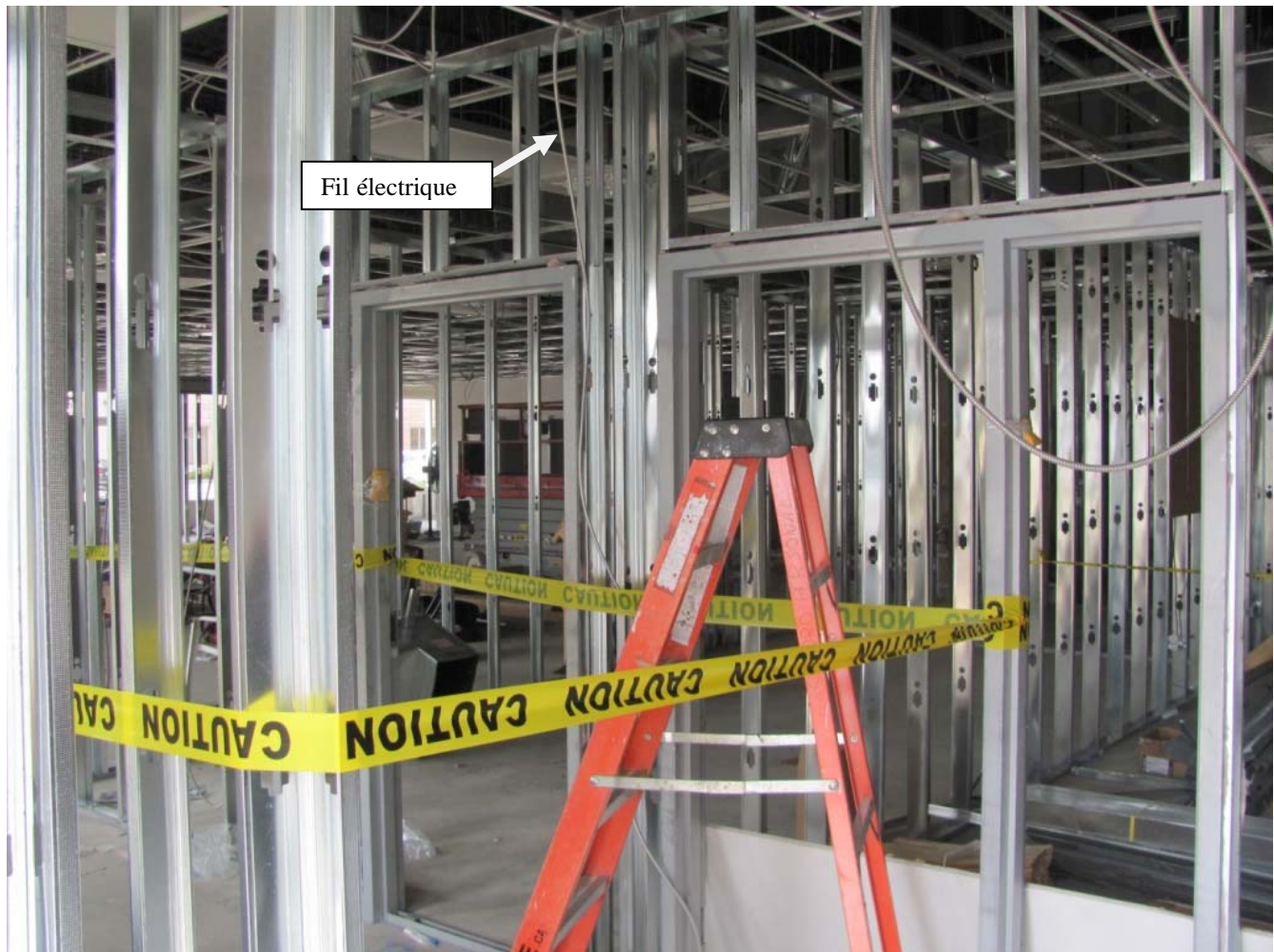
Photo 2 : Lieu de l'accident (Source : CNESST)
