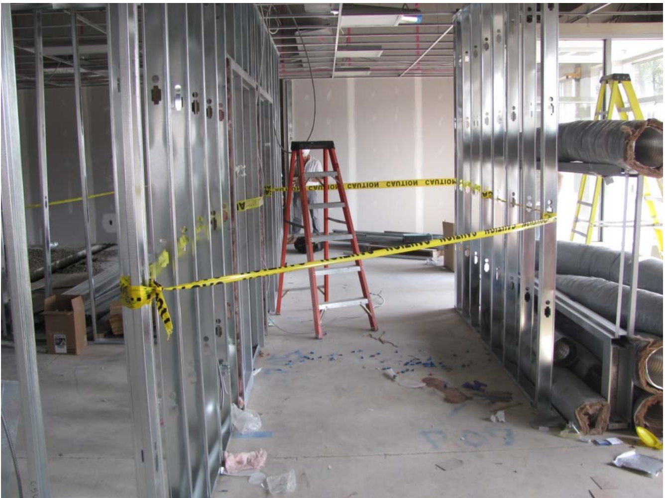
Photo 1 : Lieu de l'accident (Source : CNESST)
