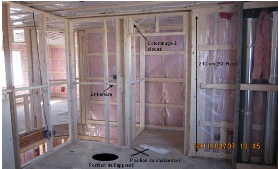
Photo N° 2 : Site de l'accident (Source CSST)
