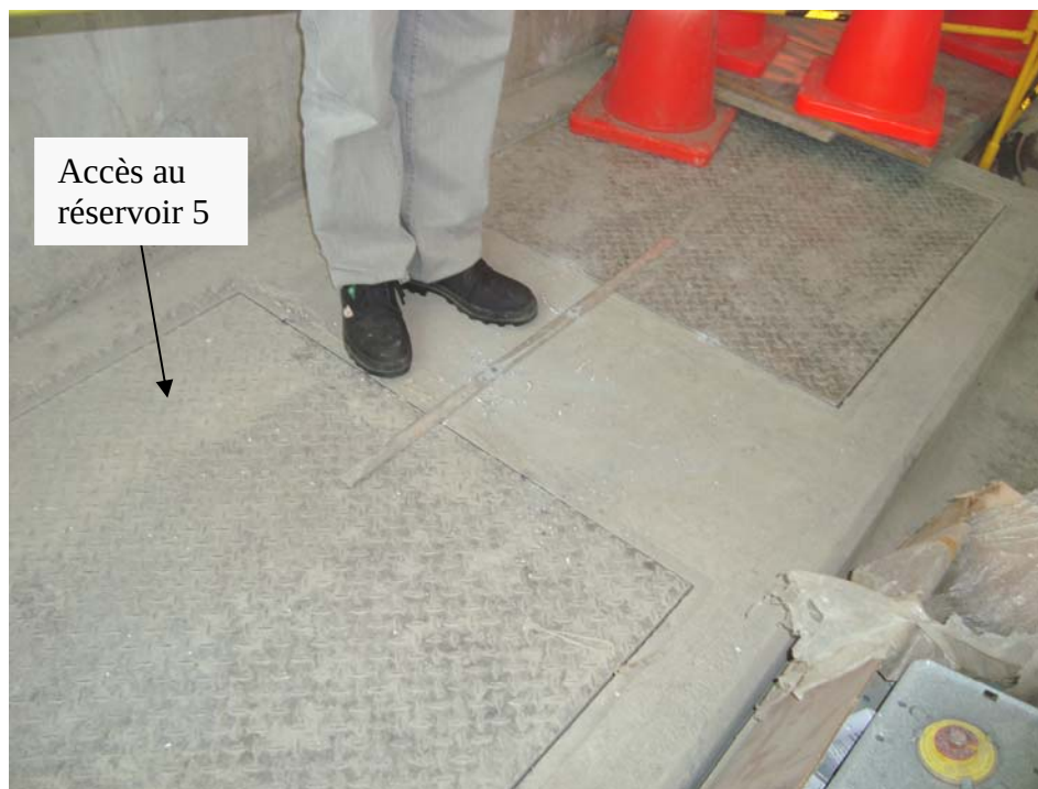
Photo 7 : Puits d'accès au réservoir 5 situé à l'intérieur du bâtiment haute pression Source : CSST
