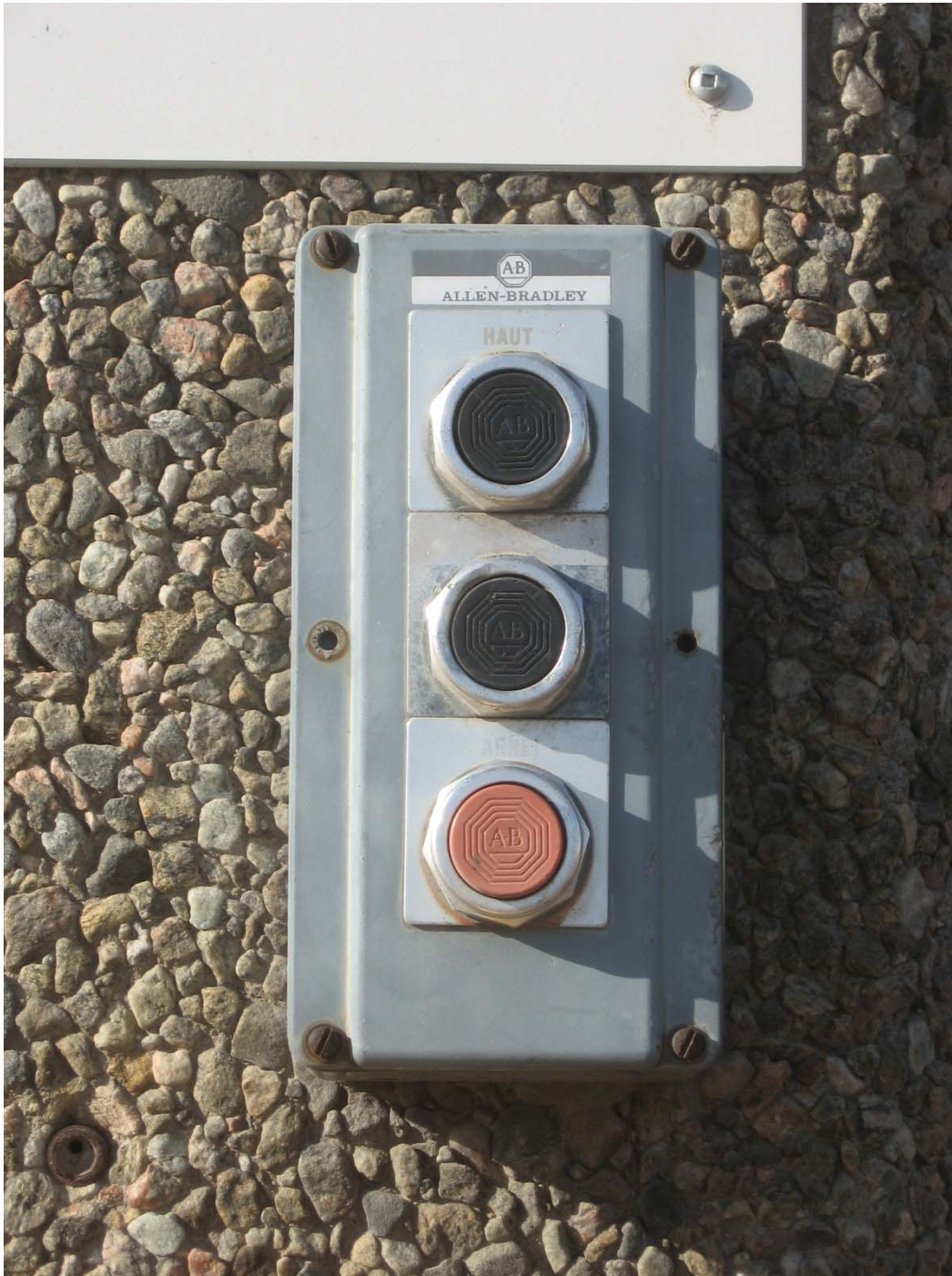
Photo 1 : Dispositif de commande de la porte
