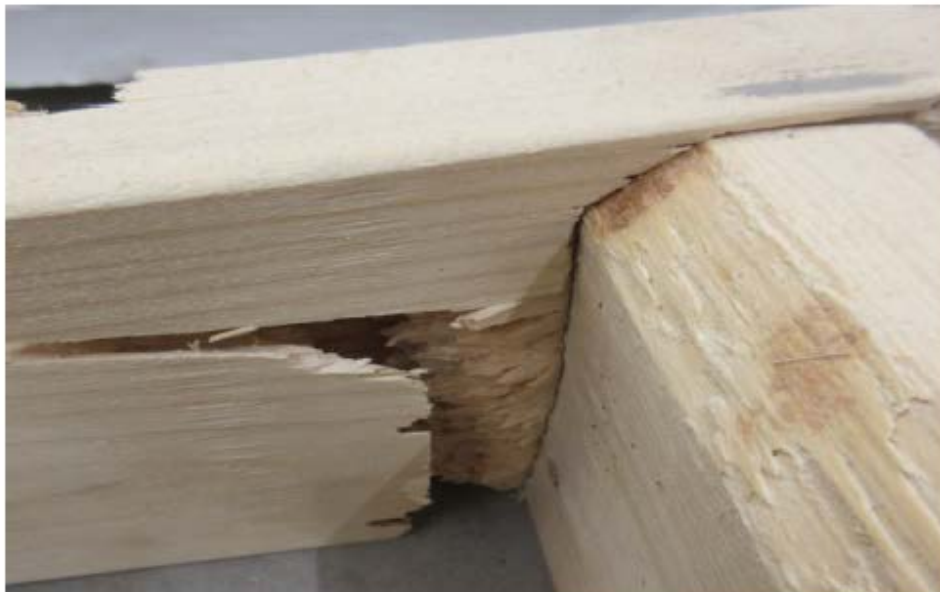
Photo 6: Endommagement de la membrure supérieure du renfort A à cause d'une résistance insuffisante en compression perpendiculaire au fil (source : CNESST)
