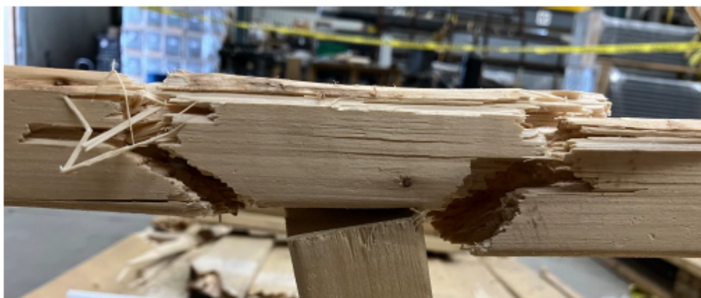
Photo 7: Les lignes de ruptures sur chaque moitié de la membrure supérieure (source : CNESST)
