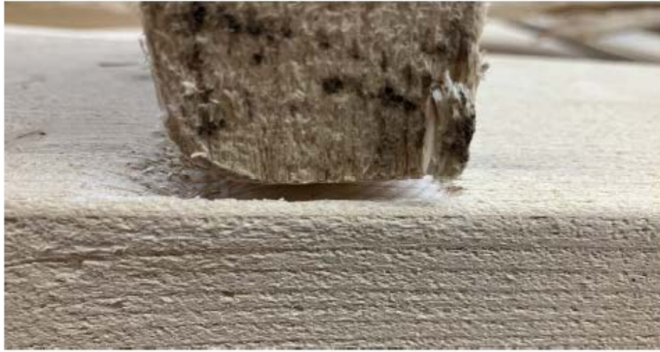
Photo 5: Endommagement de la membrure inférieure du renfort A à cause d'une résistance insuffisante en compression perpendiculaire au fil (source : CNESST)
