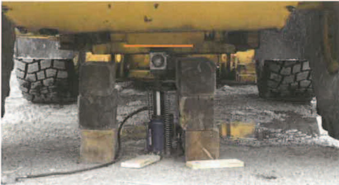
Photo 58 : Vue générale du soulèvement de la chargeuse près de la position #7 après le cadenassage montrant l'essieu en équilibre.
