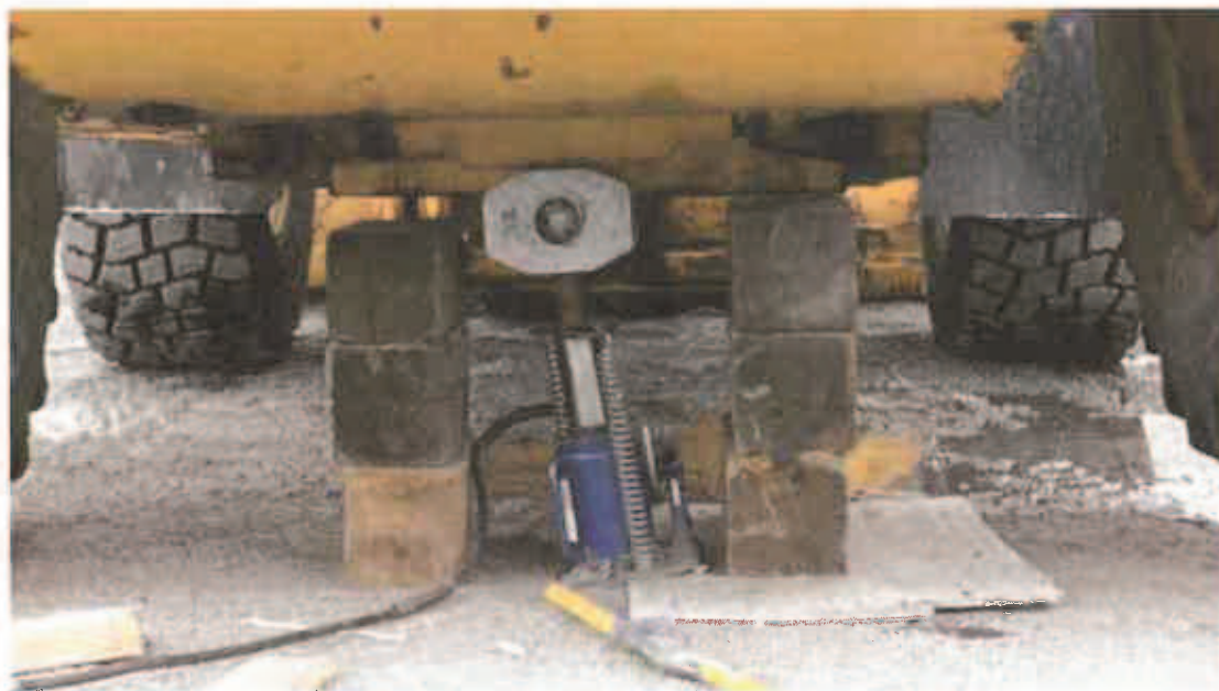
Photo 61 Vue générale du soulèvement de la chargeuse près de la position #7 alors que la base du cric n'est pas parallèle et que le bloc de rallonge est en position précaire.
