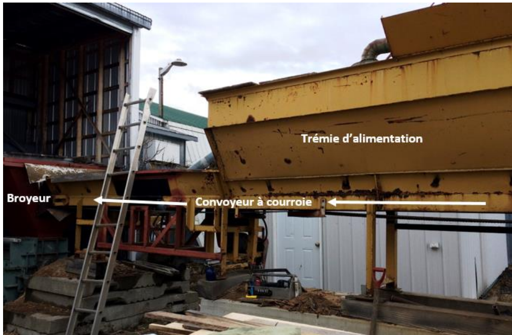
Photo 3 : Système de broyage (vue à partir du sol) Source : CNESST
