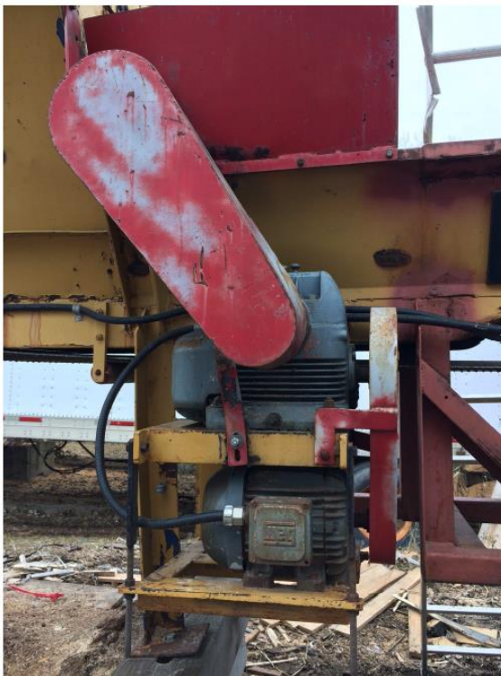
Figure 3 : Ensemble moteur réducteur de vitesse Source : CNESST
